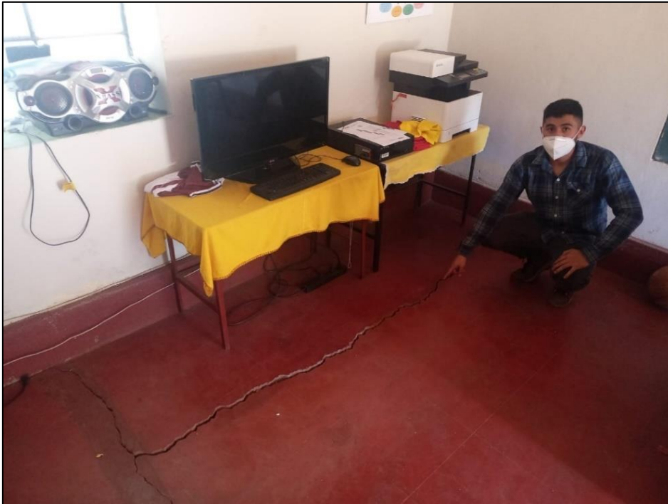
Grietas en falso piso
