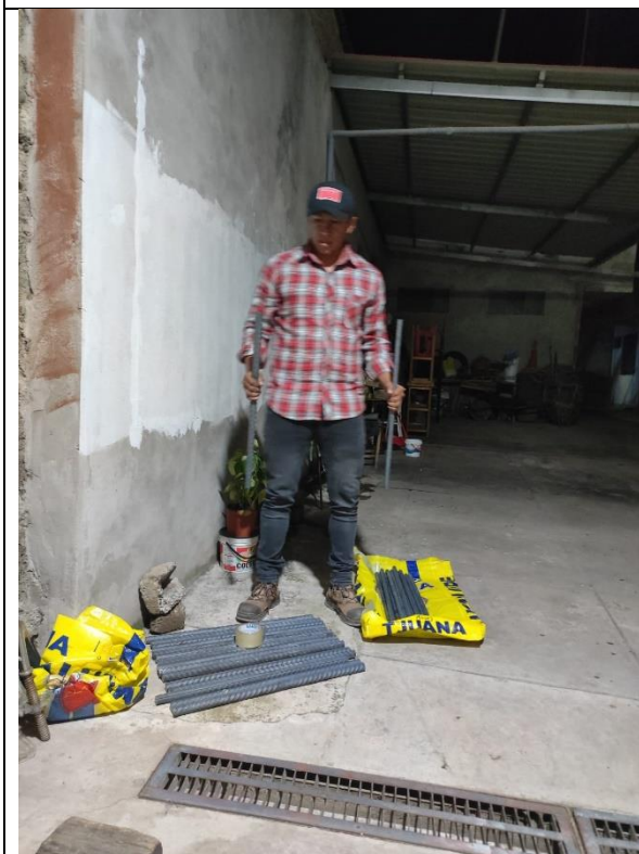
En la fotografía se puede observar los 16 aceros de 65 cm de 1" y los 16 aceros de 3/4"
