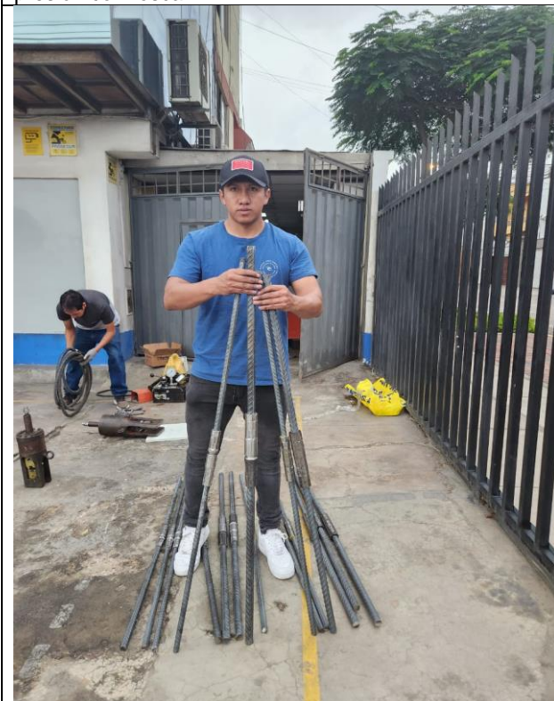
En la fotografía se puede observar todas las barras de acero, tanto de 1" como de 3/4" ya empalmadas.
