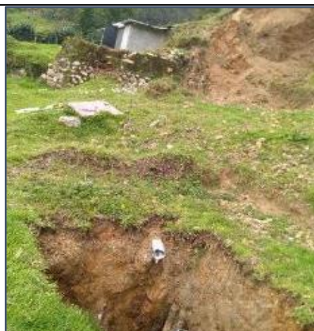
Fotografía. 22: Avería en línea de conducción de aguas residuales en letrina pública.
