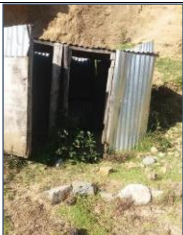
Fotografía. 19: Vista de letrinas públicas en estado de abandono.
