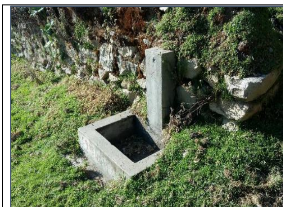
Fotografía 17: Pileta publica en estado de abandono, daños visibles en la estructura, no cuenta con la pileta o grifo.
