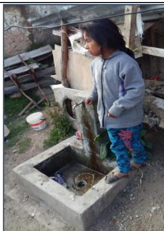
Fotografía. 20: Vista típica de piletas domiciliarias, se observa daños en estructura y fuga de agua en las piletas.
