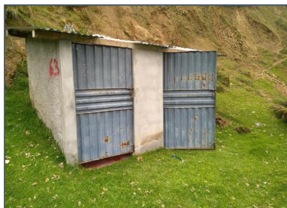
Fotografía 16: Vista de las letrinas públicas, de uso para el público en general. Se observan daños en el techo, puertas requieren mantenimiento.
