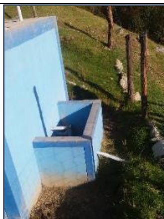
Fotografía. 12: Caja de válvulas en reservorio sin tapa, las tuberías y las llaves presentan daños por la intemperie.
