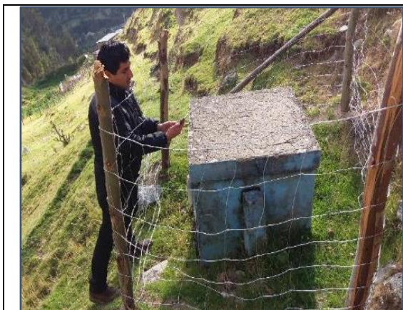
Fotografía 13: Inspección de Cámara Rompe Presión, se observa daños en la estructura, pintura deteriorada.
