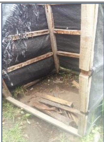
Fotografía. 21: Vista típica de letrinas o baños domiciliarios, en estado de abandono.
