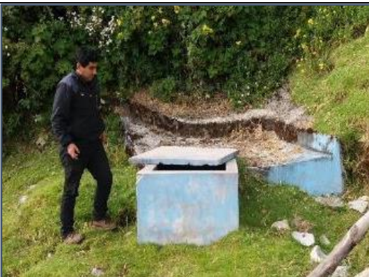
Fotografía 09: Vista desde otro ángulo de la captación.
