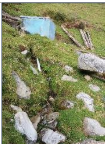
Fotografía. 15: tuberías descubierto y en proceso de deterioro por la intemperie.
