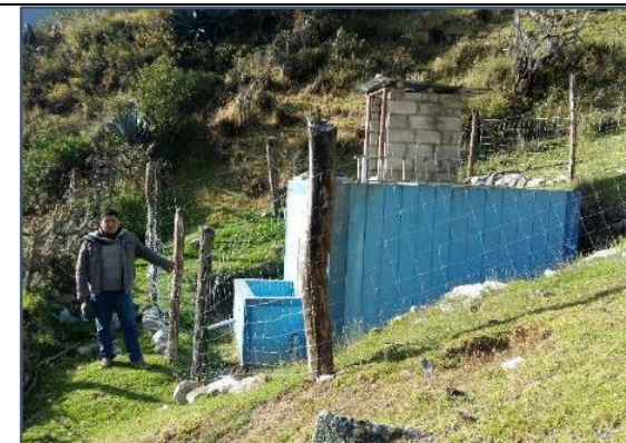
Fotografía 10: Estado actual de Reservorio, falta mejorar el cerco de protección, sistema de cloración inadecuado, daños en la caja de válvulas.
