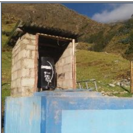
Fotografía. 11: Vista de caseta de cloración mal acondicionado y sin puerta.
