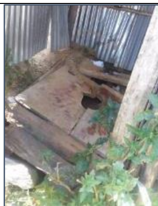
Fotografía. 18: Situación actual de letrinas, en estado de abandono.
