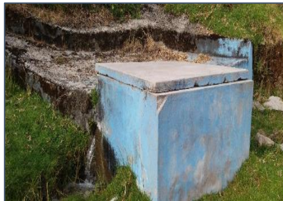
Fotografía 08: Daños visibles en la estructura, fuga de agua por el costado.
