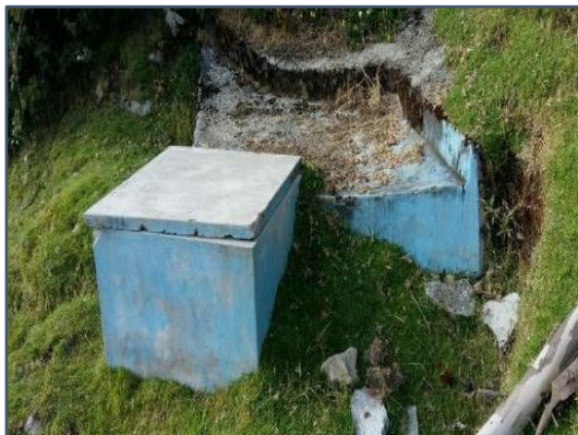
Fotografía 07: Estado actual de la Captación de Agua Potable, daños en la estructura, no tiene cerco de protección.
