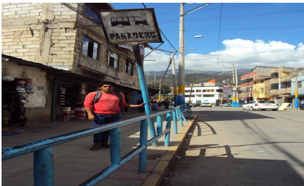
PARADERO EN ESTADO CALAMITOSO
