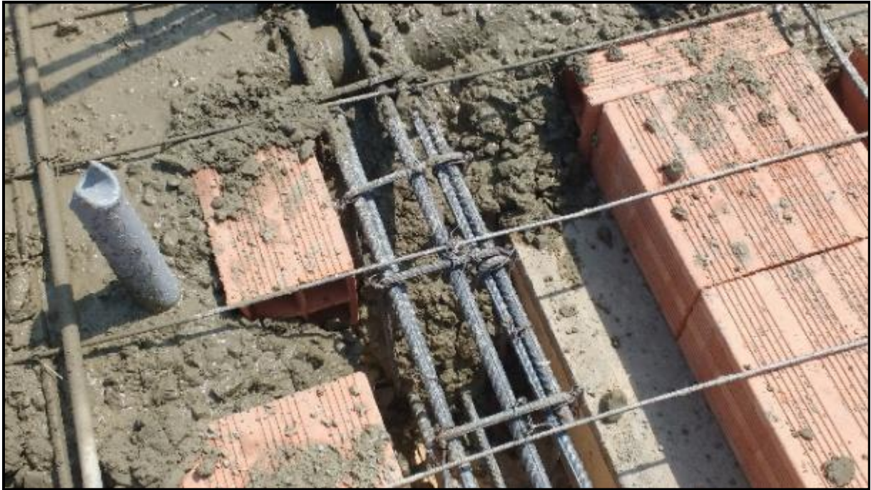
Aspectos del concreto en vivienda sin direccion tecnica.
