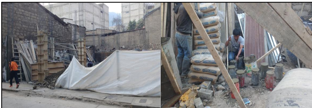
Imagen 5. 4 Encofrado de las columnas, así como también extracción de testigo de concreto
