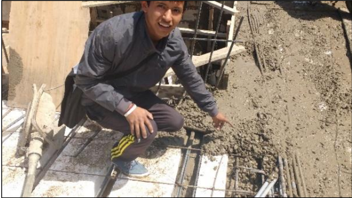
Aglomeración de agregado grueso en el concreto en vivienda sin dirección técnica
