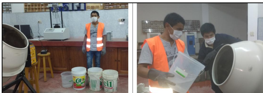
Se alistan la proporción de materiales para preparar el concreto en la mezcladora tipo trompo posteriormente realizaremos las pruebas de control.
