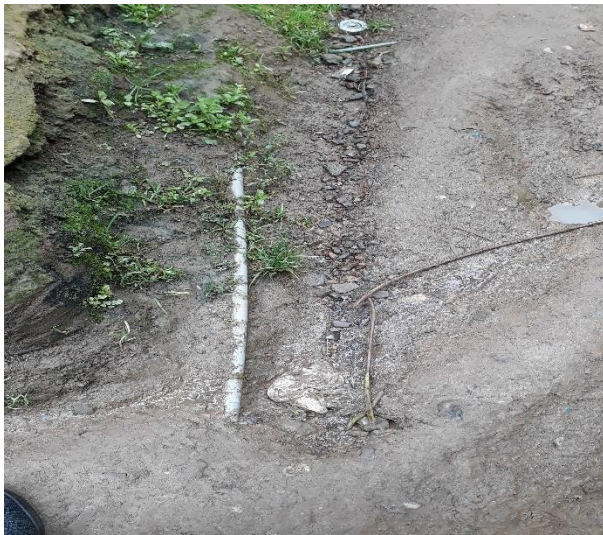
Fotografía 35: vista de tubería de distribución expuestas.
