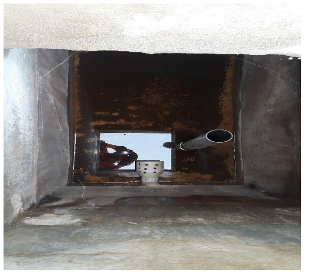
Fotografía 20: vista de cámara rompe presión sin funcionamiento.
