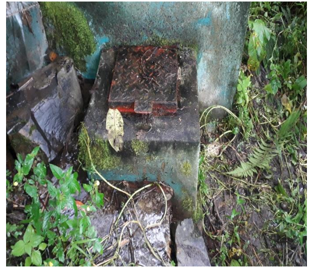
Fotografía 6: vista de caja de válvulas oxidadas.
