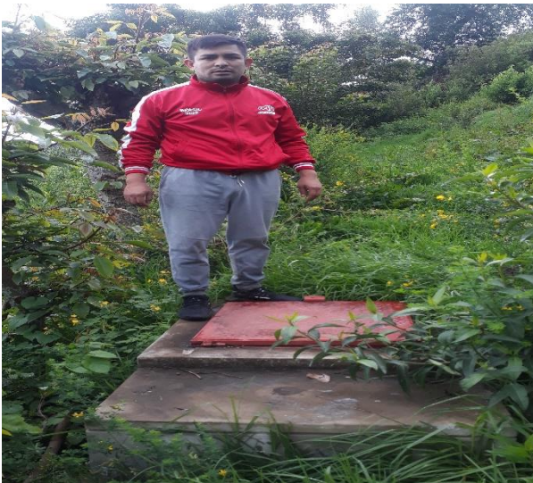
Fotografía 23: vista de cámara rompe presión sin mantenimiento.
