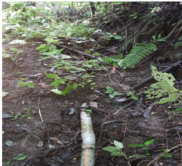
Fotografía 11: vista de tubería de línea de conducción expuesta.
