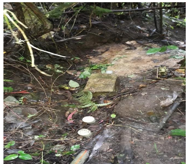
Fotografía 8: vista de tubo de rebose rota y dado seguridad.
