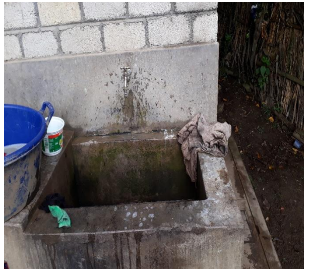
Fotografía 22: vista de piletas de cada hogar en mal estado.
