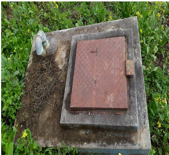
Fotografía 19: vista de cámara de rompe presión llena de tierra y sucio.
