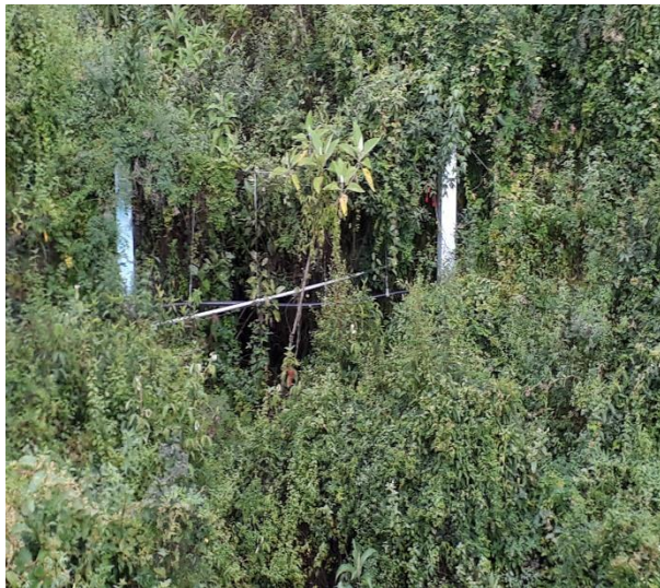
Fotografía 13: vista pase aéreo de tubería en la línea de conducción.
