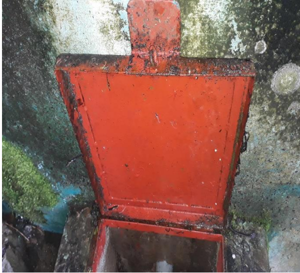
Fotografía 9: vista caja de válvulas en mal estado y con oxidos de captación de Umaccata.
