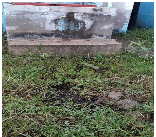
Fotografía 18: fugas de agua de reservorio por la parte de caja de válvulas.
