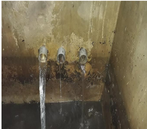
Fotografía 7: vista de cámara húmeda sucia y en mal estado de captación.
