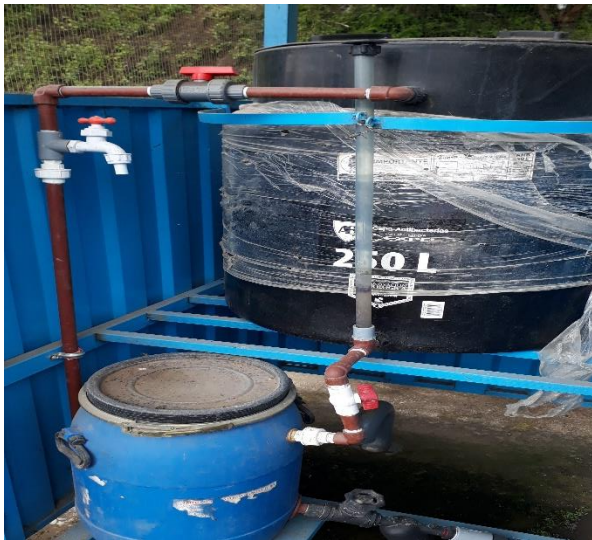
Fotografía 17: vista de caseta de cloración en mal estado.
