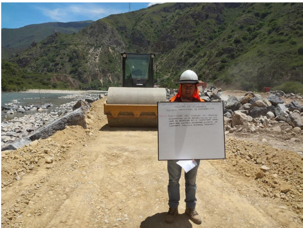
Se observa a la maquinaria rodillo liso vibratorio realizando la compactación del terraplén por capas
