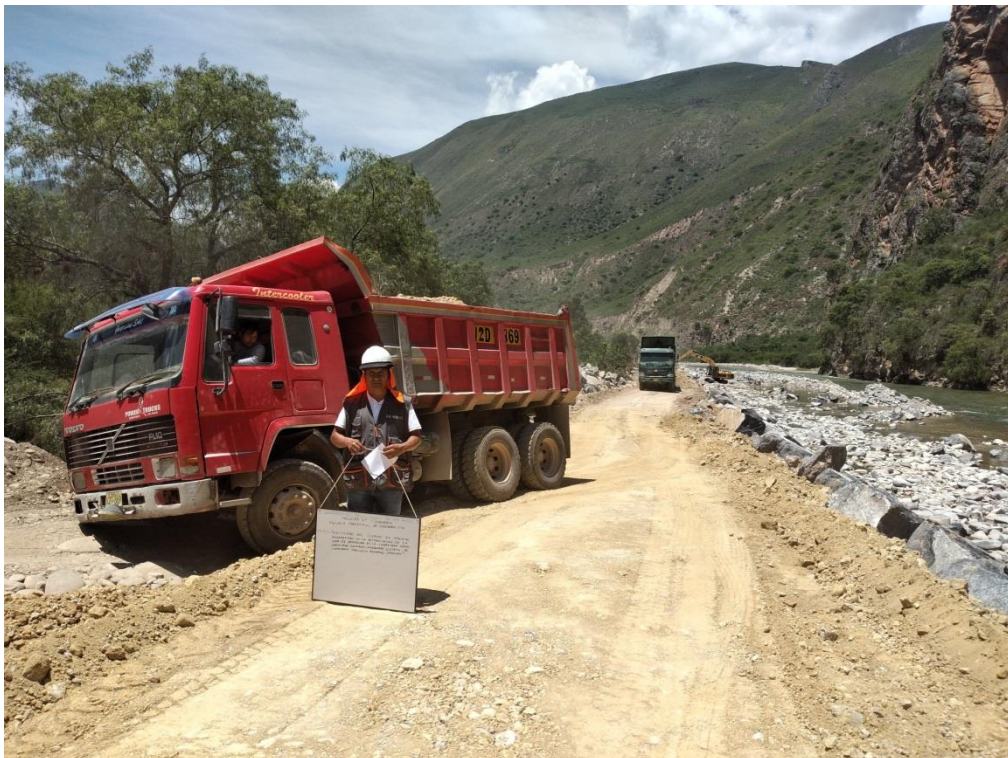
Transporte con volquetes del material de la cantera 09 para terraplén en la localidad de Santa Rosa, donde se realizó la prueba incrementando bischofita al 4%
