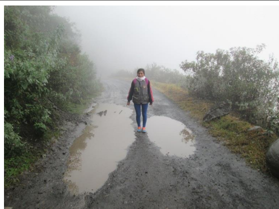
Foto 23: baches en tramos de la carretera, falta cunetas y alcantarillas.
