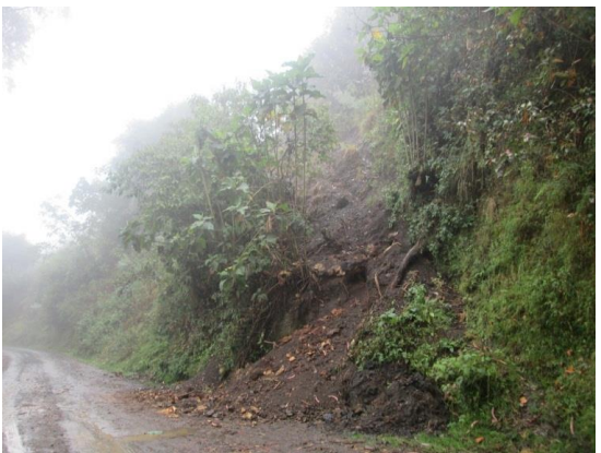
Foto 30: deslizamiento de talud, es necesario realizar banquetas.
