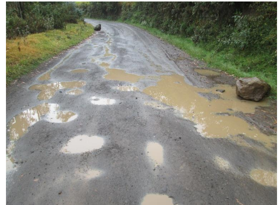
foto 20: km 08+160. Alcantarilla de concreto tipo cajon 80cm x 80cm, y zocavacion de la calzada
