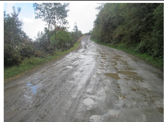
Foto 12: Baches en la calzada.
