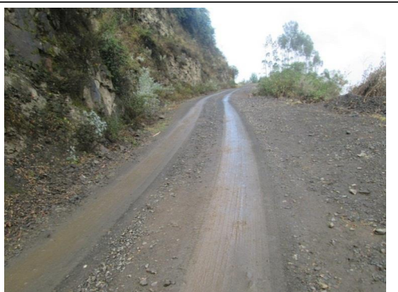
Foto 18 : zona rocosa. Calzada con perdida de materia de afirmado.
