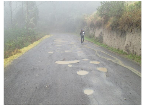
Foto 28: erosión y baches.
