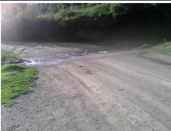
FOTO N° 15: km 15+300, Baden en regular estado de conservacion.
