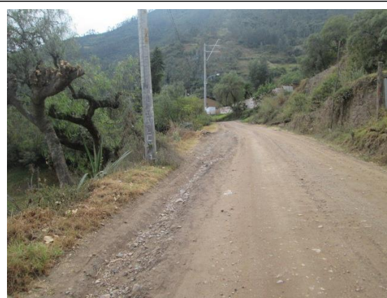
Foto 04: erosión en la plataforma por falta de cunetas laterales
