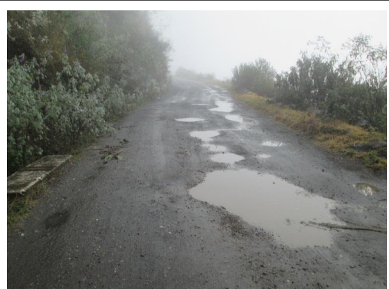
Foto 24: baches en tramos de la carretera, a pesar de existencia de cunetas.
