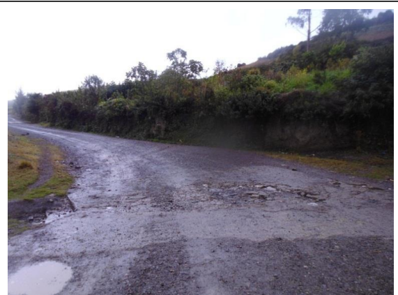
Foto 36: Badén en mal estado.
