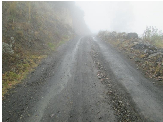
foto 27: deformación y erosión de la calzada.
