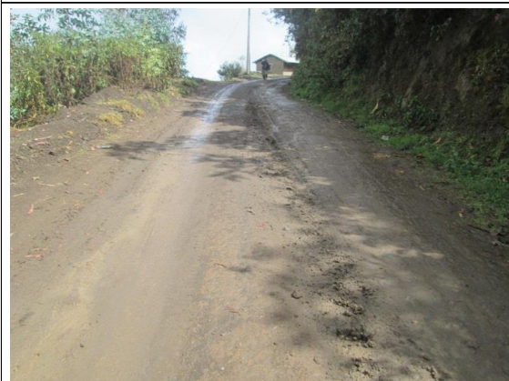
Foto 17: el material de afirmado saturado tiene un comportamiento parecido al de la arcilla, ocasionando ahuellamientos en la calzada.
