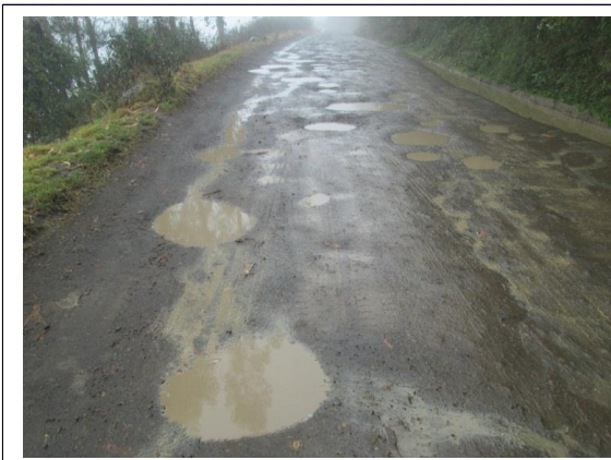
foto 25: calzada totalmente con baches.
