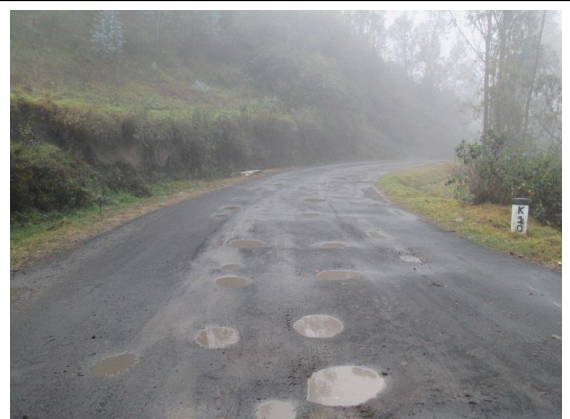
Foto 14 : Km 10+000 se observa la calzada con numerosos baches.
