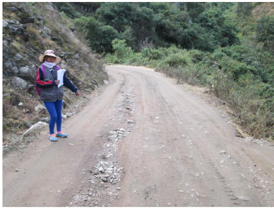
Foto 07: Erosion de la calzada, no existe cunetas laterales
