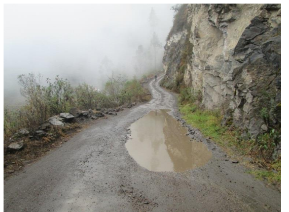
foto 16: Zona rocosa con pendiente pronunciada, se observa un lodazal a pesar de que existe una alcantarilla.
