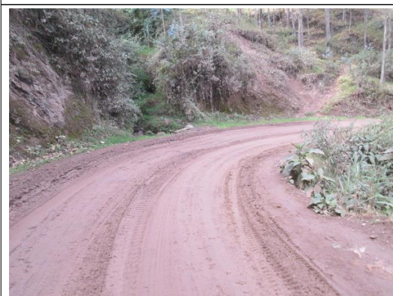
Foto 05: Curva de volteo, terreno con presencia de material arcilloso .
