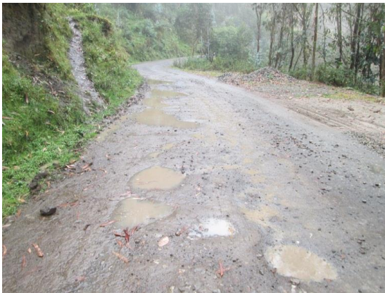
Foto 29: falta cunetas laterales.
