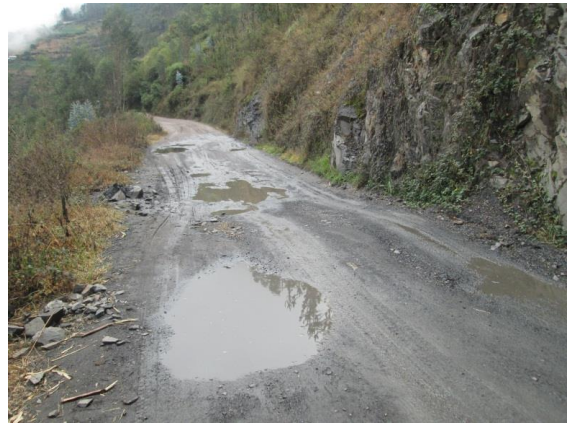
Foto 10: Deformacion de la calzada, presencia de lodasal por falta de cunetas laterales y alcantarillas .
