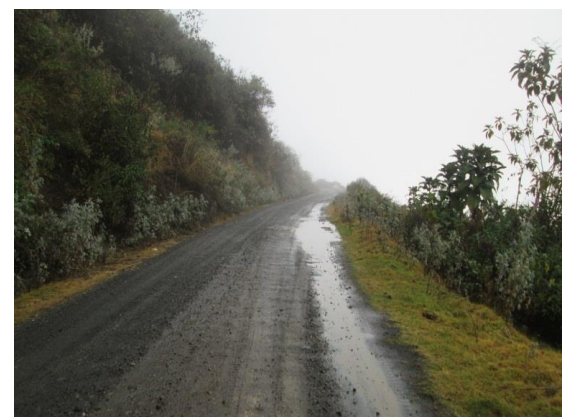
Foto 22: calzada erocianada por el curso de agua supeficial.
