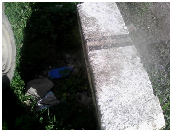
FOTO N° 14: Alcantarilla obstruida con tierra y basura.
