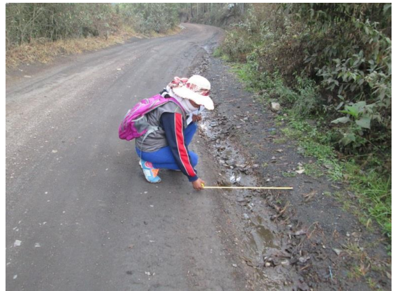
Foto 08: Erosion de la calzada, no existe cunetas laterales
