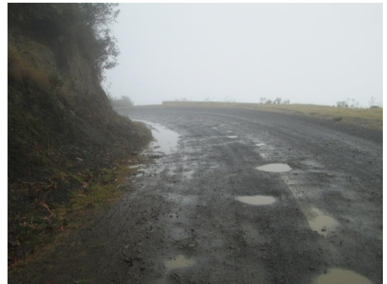
foto 26: curva de volteo, acumulación de agua superficial por cuneta con pendiente inadecuada.
