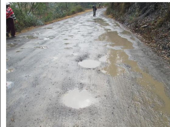
foto 15: baches y lodasales en calzada, no hay cunetas laterales.
