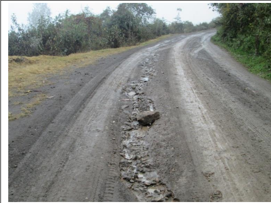
Foto 13 : Erosion de la calzada ocasionada por ausencia de cunetas laterales.
