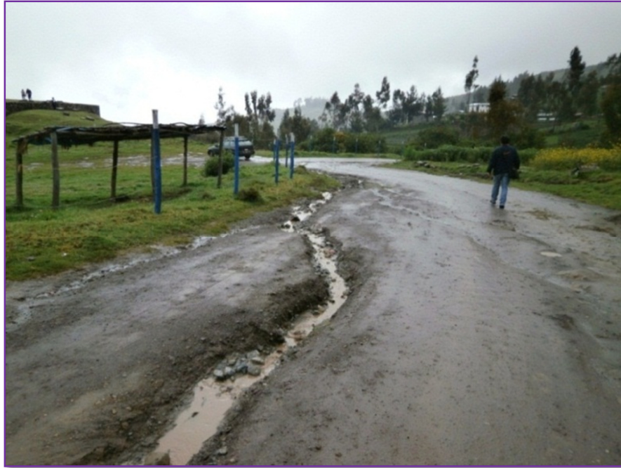
Figura 8. Diagnostico en la progresiva KM 1+020
