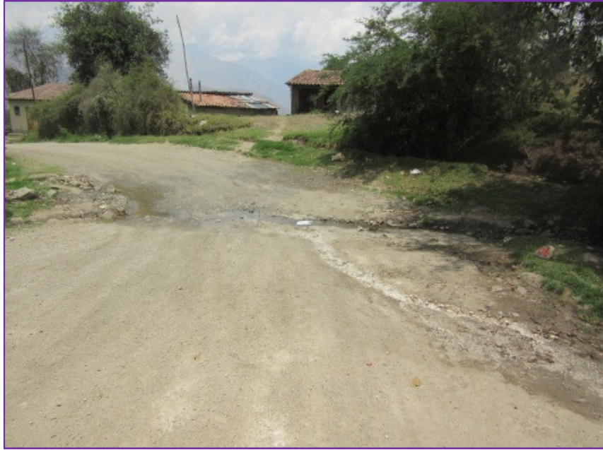
Figura 23. Diagnostico en la progresiva Km 18+900.
