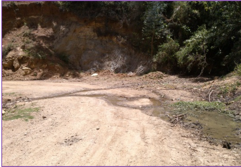
Figura 19. Diagnostico en la progresiva Km13+620
