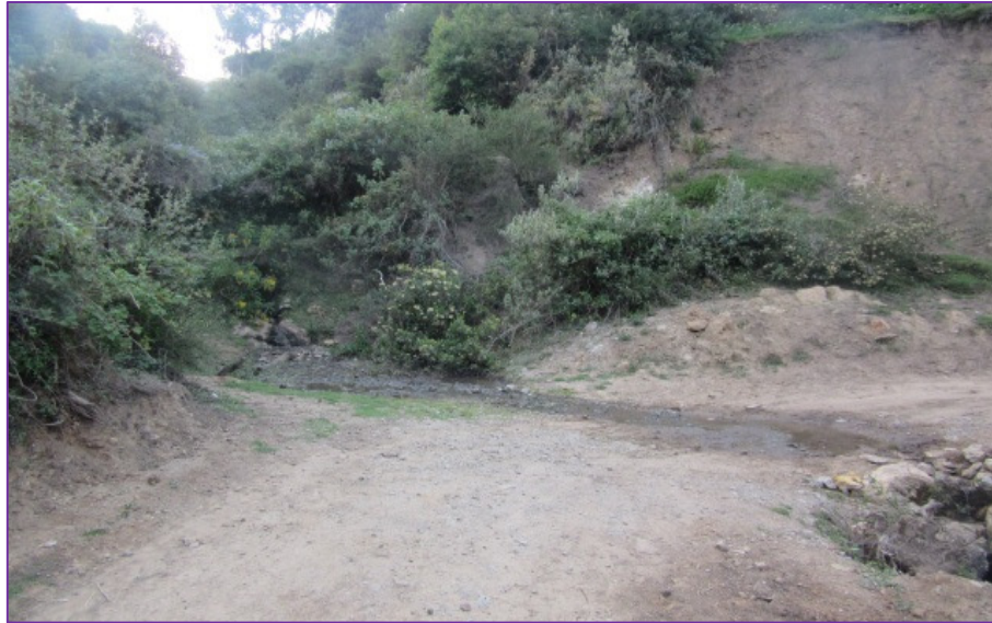
Fotografía 3: Pase de agua en mal estado en la progresiva KM 07+580 Fuente: Elaboración Propia
