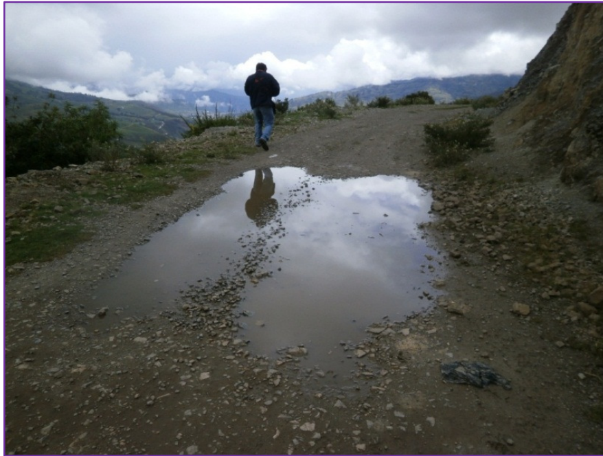
Figura 12. Diagnostico en la progresiva Km 04+980
