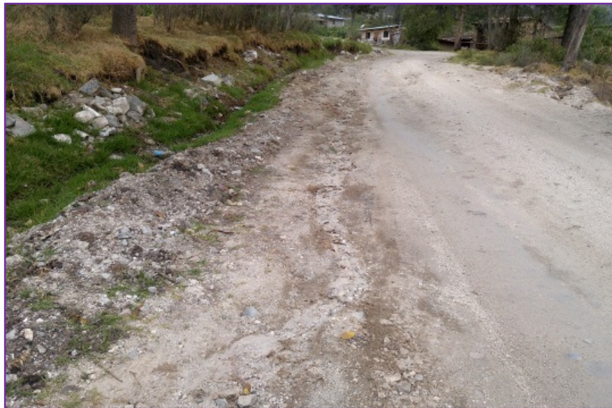
Figura 24. Diagnostico en la progresiva Km 20+300.
