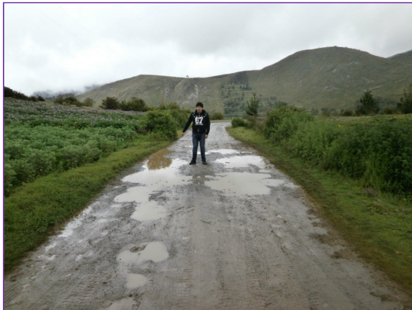
Figura 10. Diagnostico en la progresiva 02+350.
