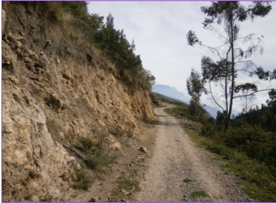
Figura 26. Zona crítica en la progresiva KM 7+540
