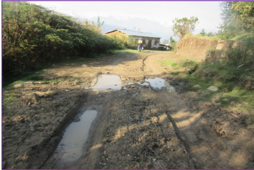
Figura 20. Diagnostico en la progresiva Km 16+580
