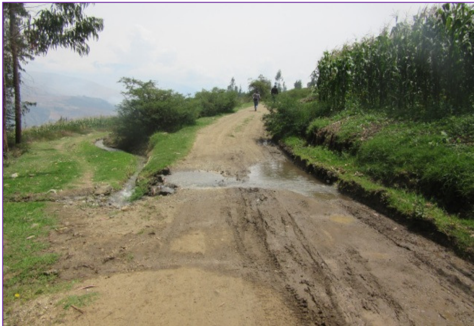
Fotografía 6: Pase de agua en mal estado en la progresiva 18+557 Fuente: Elaboración Propia
