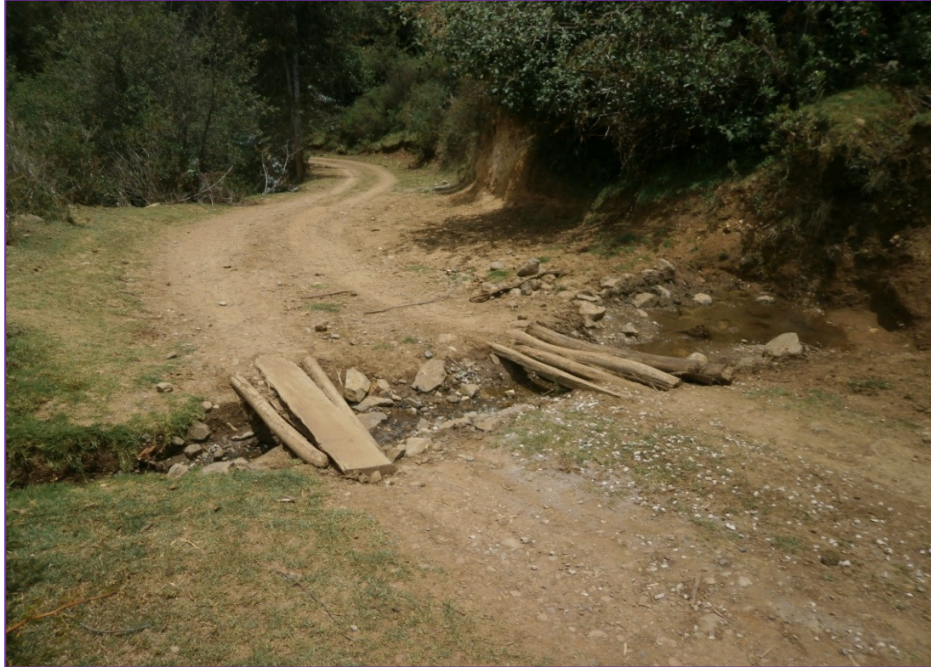
Fotografía 5: Pase de agua en mal estado en la progresiva KM 17+544 Fuente: Elaboración Propia
