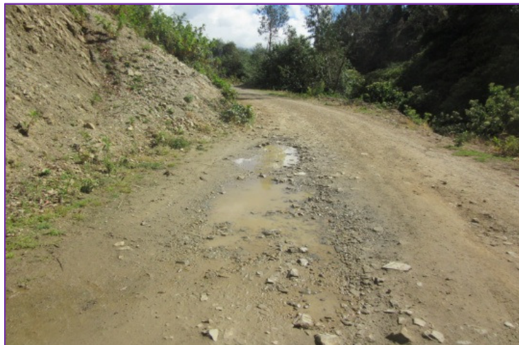
Figura 17. Diagnostico en la progresiva km 10+200.
