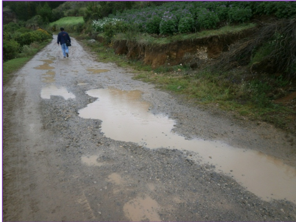
Figura 11. Diagnóstico en la progresiva Km 03+580
