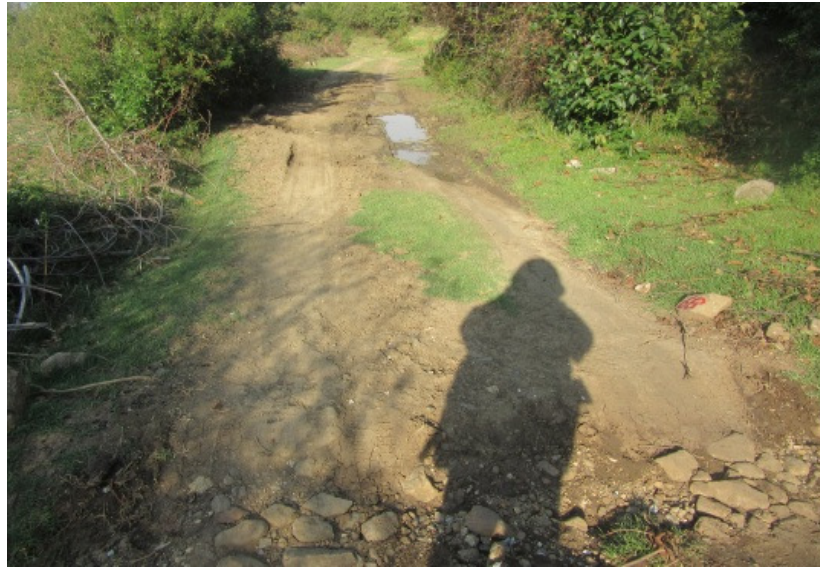
Figura 22. Diagnostico en la progresiva Km 17+470.
