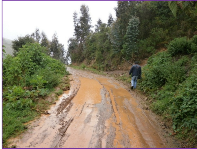
Figura 13. Diagnostico en la progresiva Km 05+280
