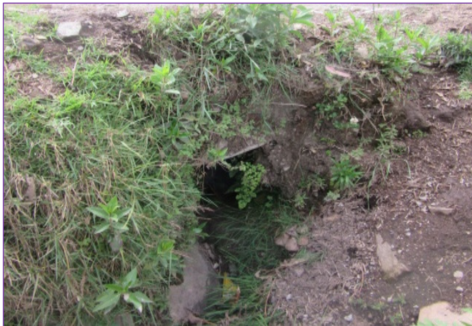
Fotografía 2: Alcantarilla de piedra en estado regular en la progresiva KM 1+957
