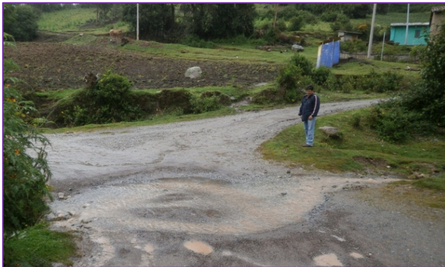
Figura 9. Diagnostico en la progresiva KM 1+500
