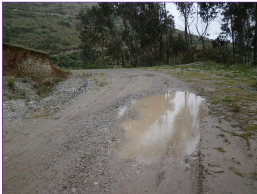
Figura 15. Diagnostico en la progresiva KM 7+180.
