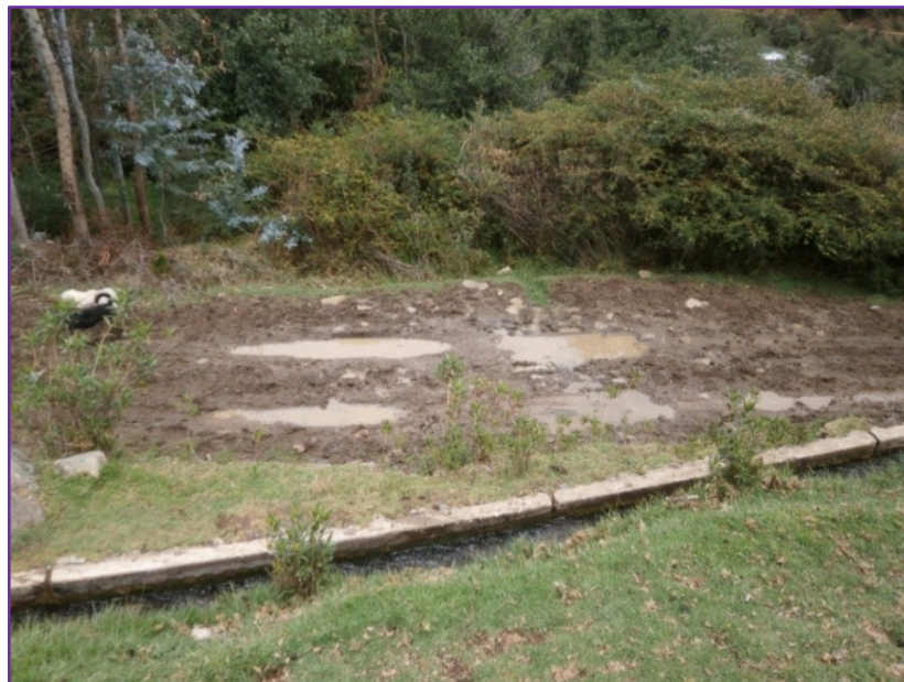
Figura 21. Diagnostico en la progresiva 16+560.
