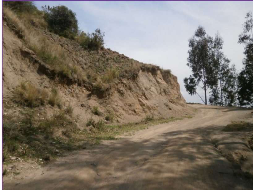
Figura 18. Diagnostico en la progresiva Km 12+430
