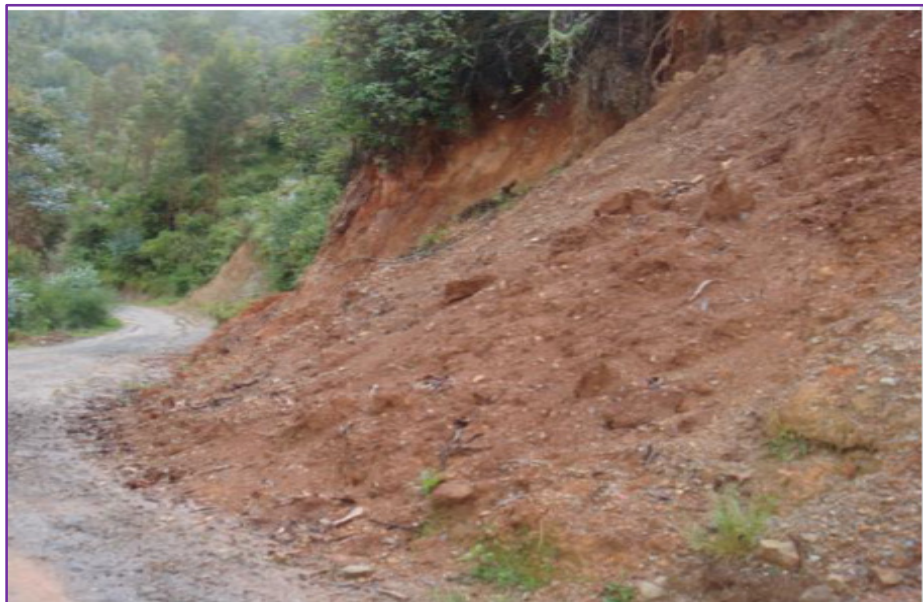
Figura 27. Zona crítica en la progresiva Km 10+000
