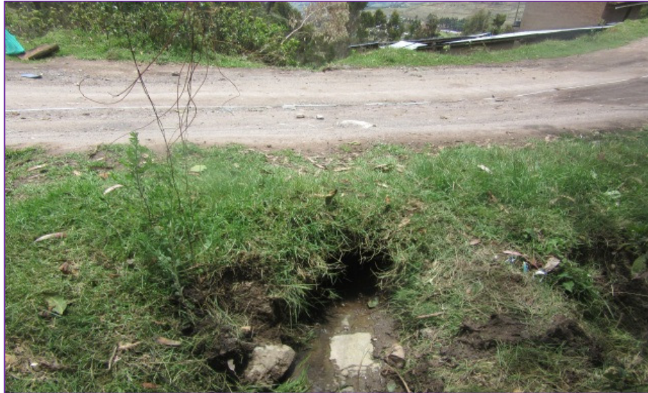
Fotografía 1: Pase de agua en estado regular en la progresiva KM 0+650
