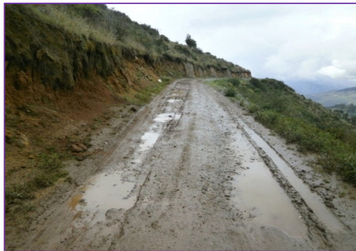
Figura 14. Diagnostico en la progresiva 6+080
