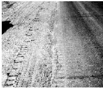
Fisura de Reflexión de Junta – Baja Severidad
