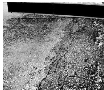
Abultamientos y Hundimientos – Alta Severidad
