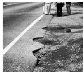
Fisura de Borde – Alta Severidad
