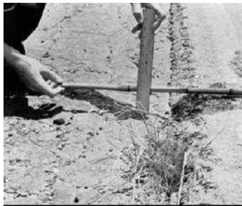
Desnivel Sentido-Berma – Media Severidad
