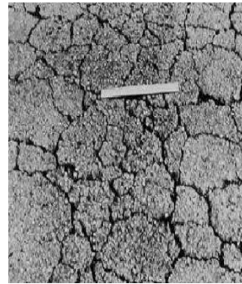
Piel de Cocodrilo – Alta Severidad
