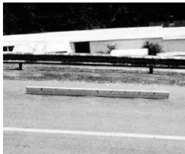
Corrugación – Media Severidad
