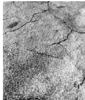
Fisuras en Bloque – Alta Severidad
