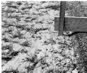
Desnivel Sentido-Berma – Baja Severidad
