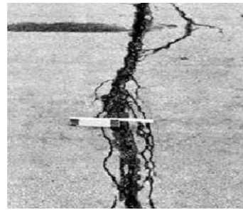
Fisura de Reflexión de Junta – Alta Severidad
