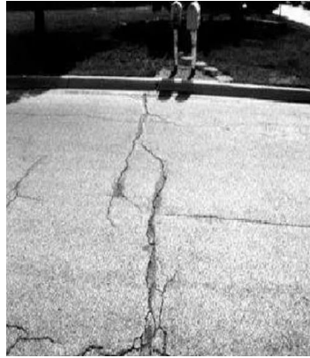
Fisuras en Bloque – Media Severidad
