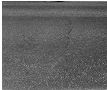
Fisura Longitudinal y Transversal – Baja Severidad
