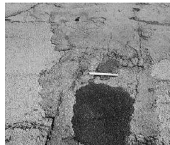
Parches y Parches de Cortes Utilitarios – Alta Severidad
