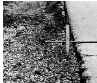
Desnivel Sentido-Berma – Alta Severidad
