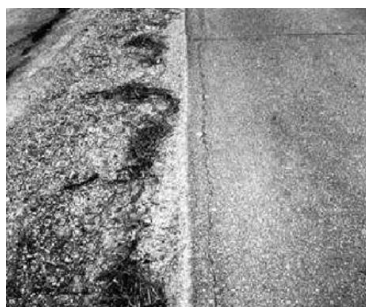
Fisura de Borde – Baja Severidad
