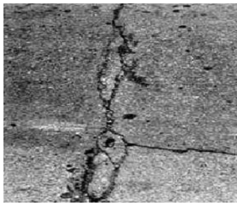
Fisura de Reflexión de Junta – Media Severidad
