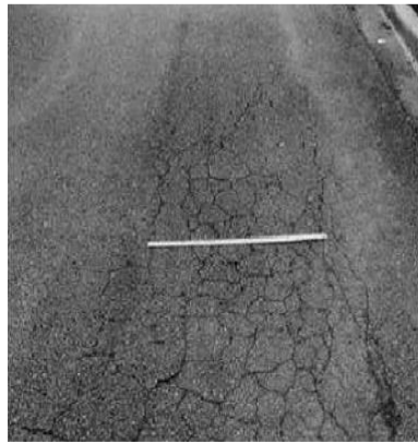
Piel de Cocodrilo Mediana Severidad
