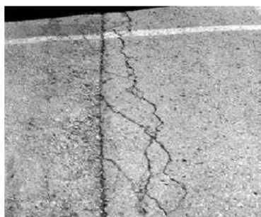
Fisura de Borde – Media Severidad
