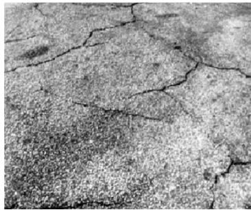
Abultamientos y Hundimientos – Baja Severidad
