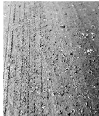
Exudación – Alta Severidad
