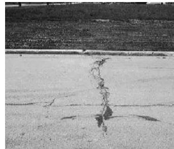
Fisura Longitudinal y Transversal – Alta Severidad
