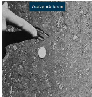
Exudación – Media Severidad
