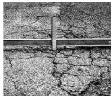
Depresión – Alta Severidad
