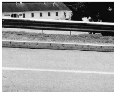
Corrugación – Baja Severidad
