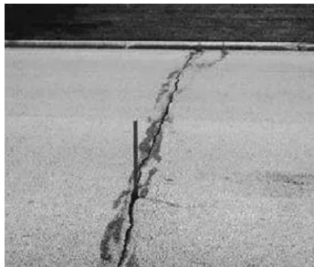
Fisura Longitudinal y Transversal – Media Severidad
