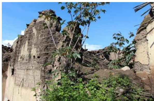
figura 18. Caída de muro por factor pluvial
