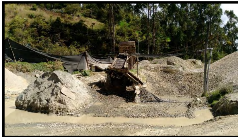
Ilustración 4-12 Planta Trituradora de Material Grueso
