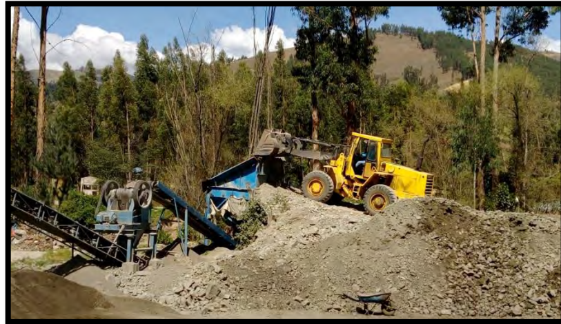
Ilustración 4-9 Alimentación del Material para el proceso de Trituración
