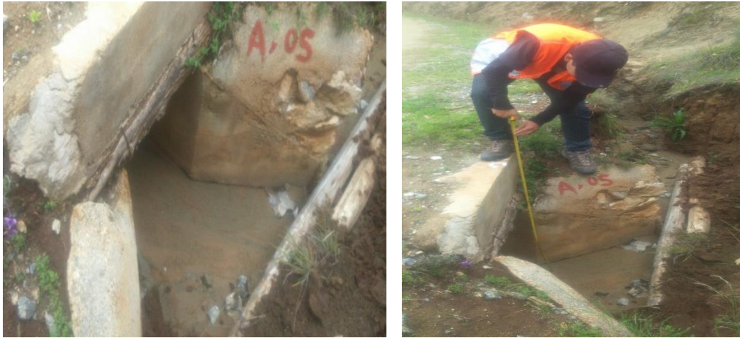
Figura 1: Alcantarilla ubicada en la Progresiva Km 1+525, se encuentra obstruida, tiene una longitud de 4.50 m, cuya sección de entrada y salida es de 0.50x0.50, y condición estructural está en malas condiciones, por tanto necesita ser reemplazado.
