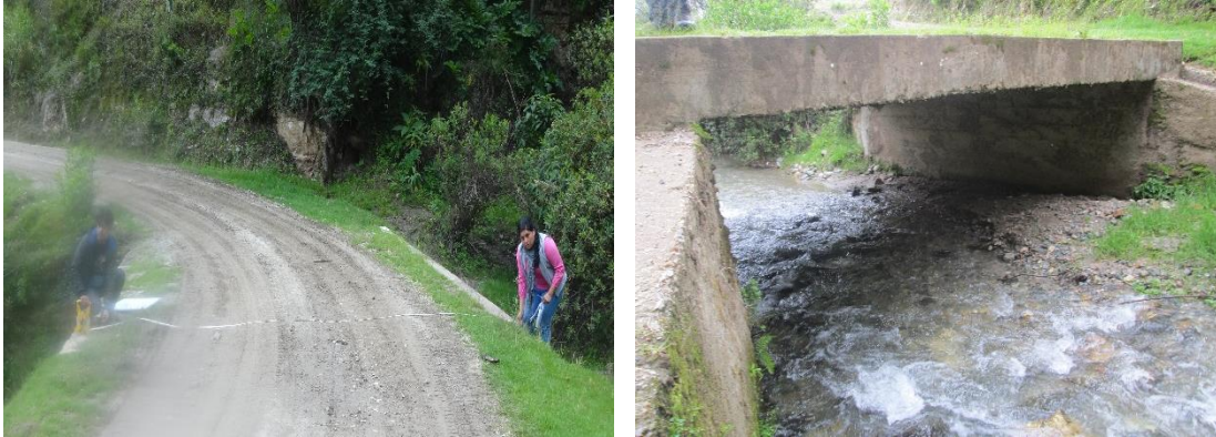
Figura 4: Pontón en estructura de malas condiciones, debiendo ser reemplazada por un puente carrozable nuevo acorde a las condiciones de tránsito (ligero y pesado).
