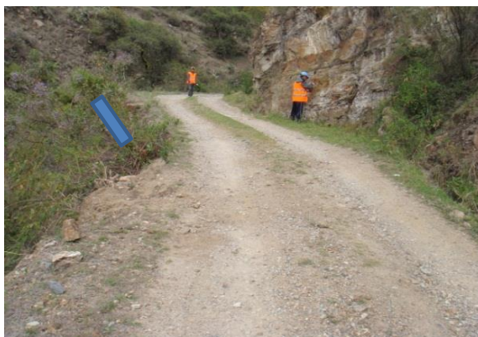
Figura 5: Muro de piedra que no garantiza la estabilidad al peso de los vehículos pesados, se propone realizar un Muro de Concreto ciclópeo, según diseño.
