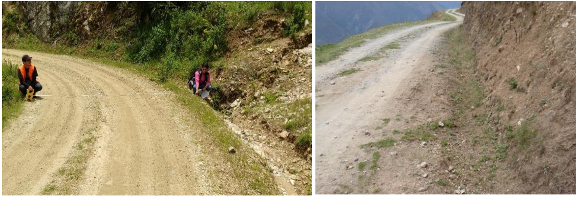
Figura 3: Cuneta de tierra en la progresiva 10+000 se encuentran obstruidas, y en algunas partes de la carretera del tramo no existen cunetas longitudinales necesarias para evacuar las aguas pluviales.
