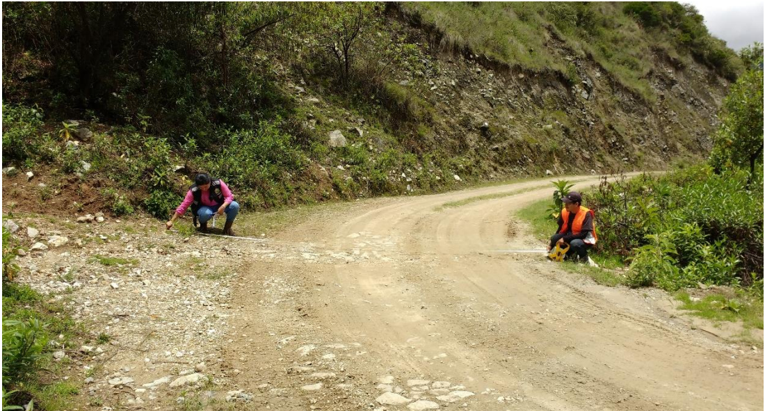
Figura 2: Badén de la progresiva Km. 05+138, con 30% de piedra y 70% en tierra, permite dar pase a los flujos de material sólido y caudal líquido, dicho badén se encuentra colapsada, por tanto necesita ser remplazada por un badén de Concreto ciclópeo.
