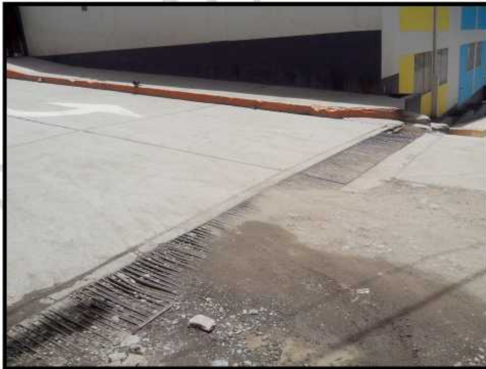
Foto N° 04: Se observa el sumidero colapsado por falta de mantenimiento
