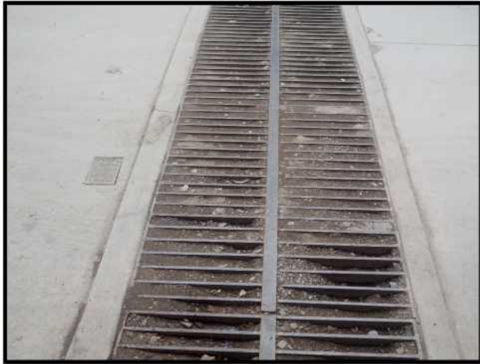
Foto N° 05: Se observa el colapso del sumidero por falta de mantenimiento Calle Tacna
