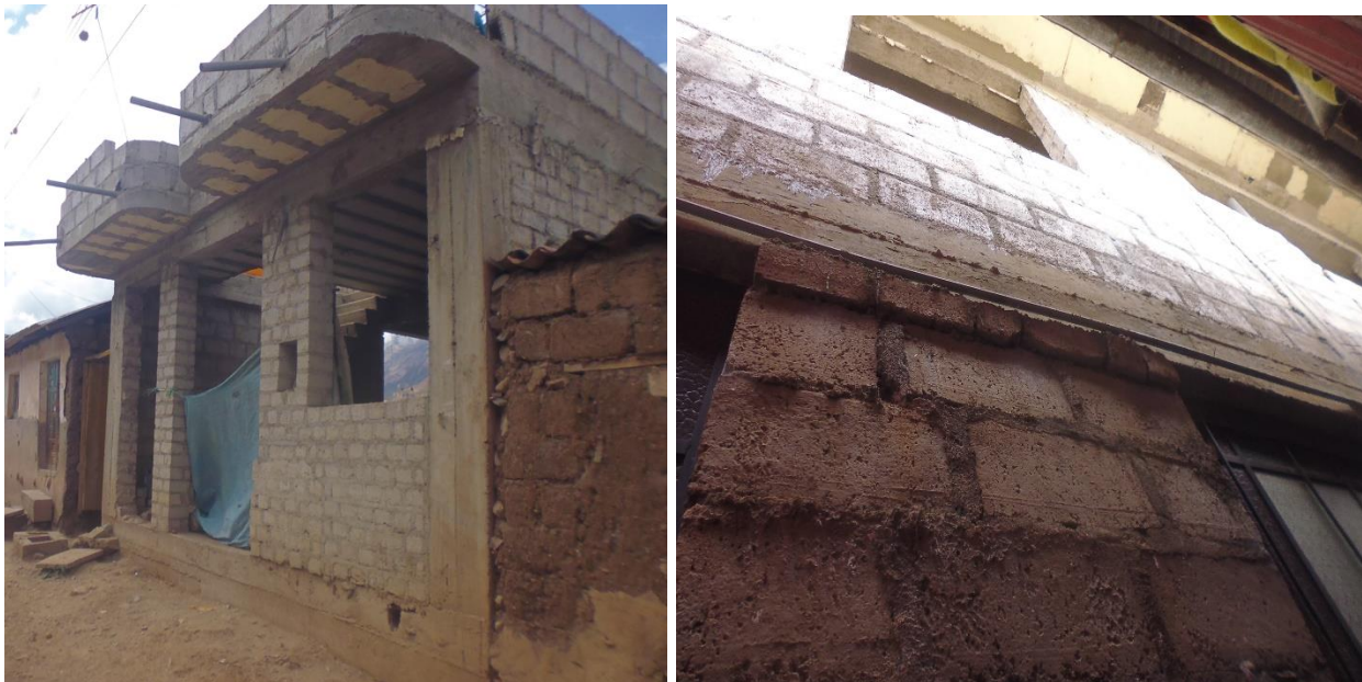
FOTO D-11: Se observa la fachada y falta de confinamiento de la vivienda evaluada.
