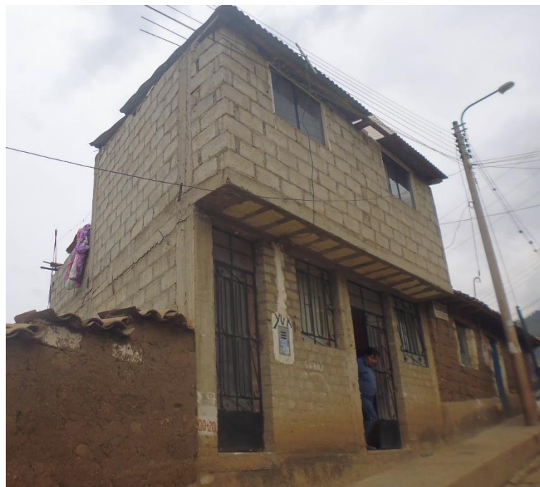
FOTO D-48: Falta de simetría y deficiencias en la construcción de la vivienda.
