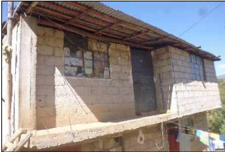
Figura 5.26: Edificación con cubierta inestable de material liviano.
