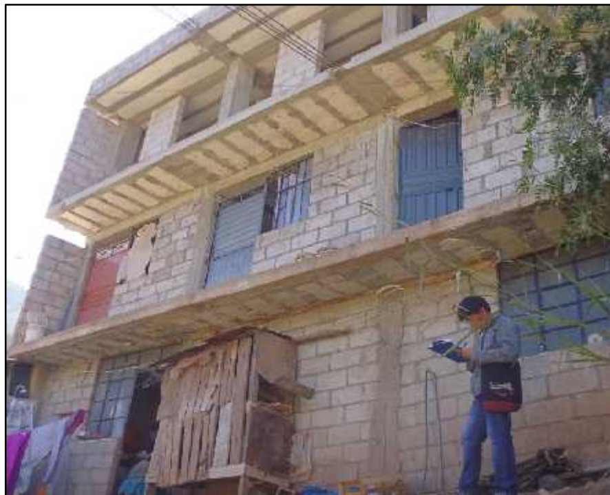
Figura 5.9: No existe continuidad de muros de entrepisos.
