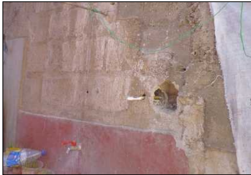
Figura 5.7: Muro portante deteriorado.
