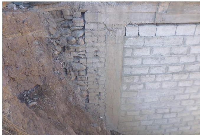
Foto D-3: Muro soportando el empuje lateral del terreno sin diseño para actuar bajo este efecto.
