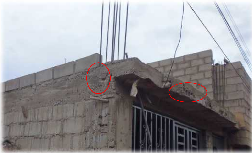
Figura 1.2: El acero de refuerzo de la viga está expuesto a la intemperie y falta la viga de borde, no cumple el recubrimiento mínimo según la norma E-070.
