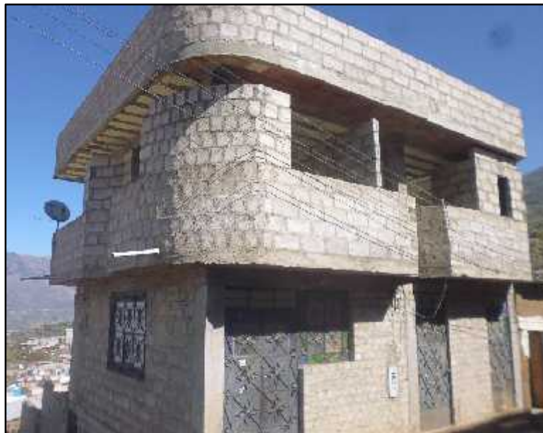
Figura 6.19: Ausencia de confinamiento en la unión muro viguetas de losa aligerada.
