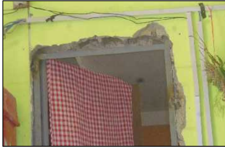
Figura 5.3: Se modificó el muro portante para cambio de uso.
