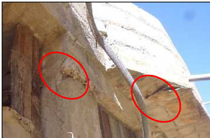
Figura 6.15: Uso de bolsa de cemento y triplay en encofrado de viga losa.
