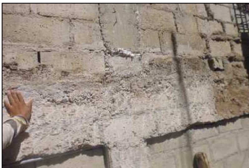
Figura 5.2: Muros portante sin confinamiento con las vigas y columnas, se observa también que no existe continuidad en el sistema resistente.
