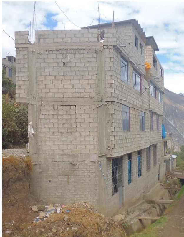
FOTO D-50: Falta de simetría y deficiencias en la construcción de la vivienda.
