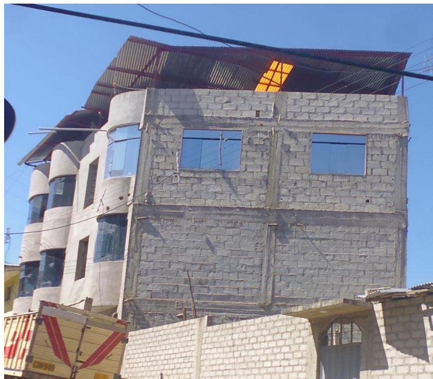
FOTO D-43: Se observa la fachada y falta de simetría en planta de la vivienda.
