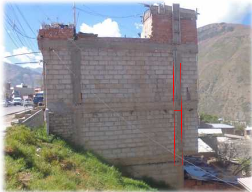
Figura 1.5: Vivienda construida en una pendiente pronunciada, no se mantiene la continuidad del ancho de la columna.
