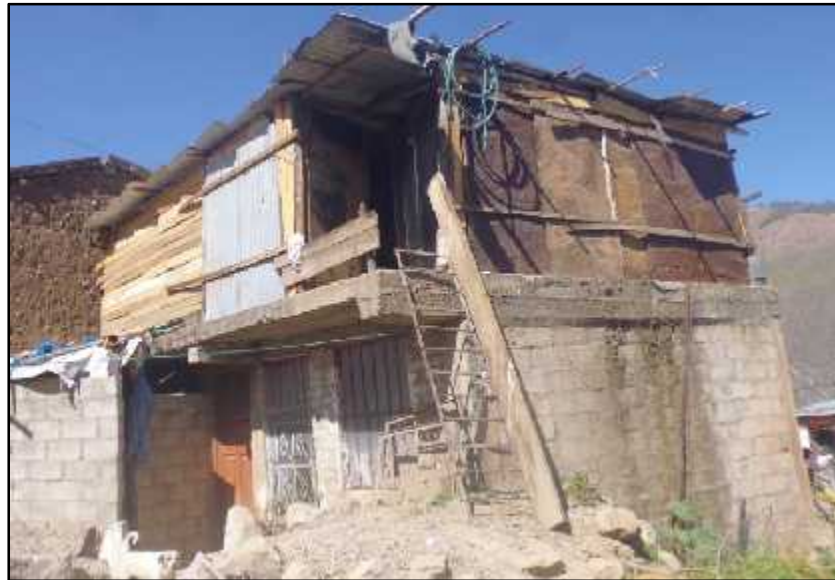
Figura 5.33: muro y columnas en estado deteriorado y construcción provisional en condiciones inhabitables.
