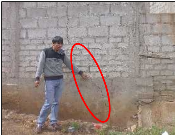
Figura 6.2: Muro agrietado por asentamientos diferenciales
