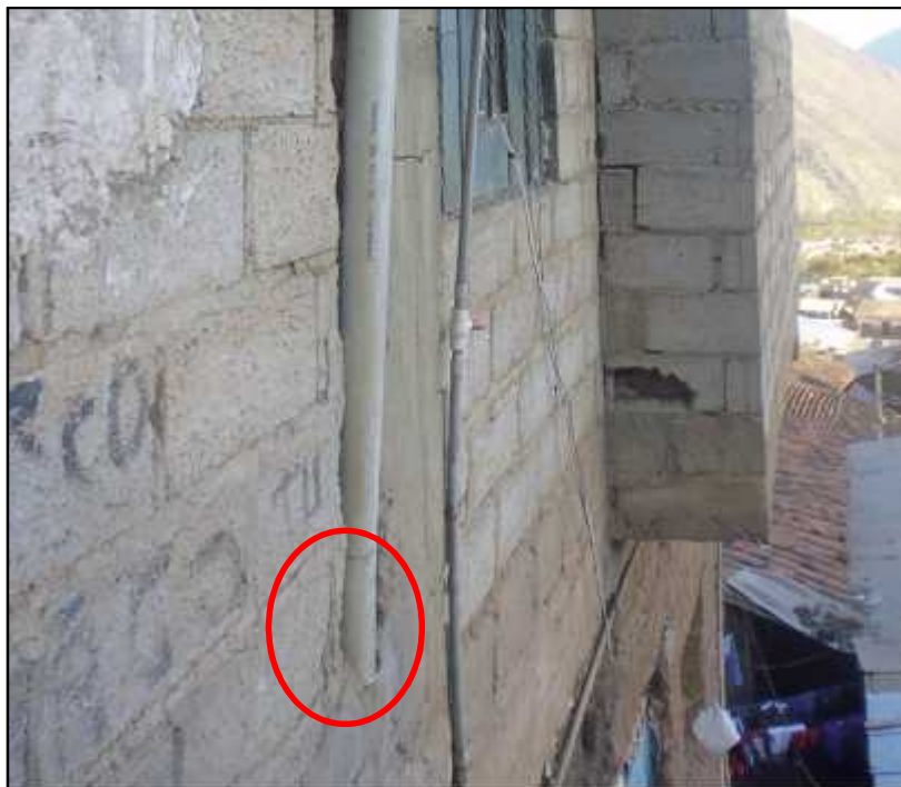
Figura 5.10: Edificación con instalaciones sanitarias que cruzan elementos estructurales.
