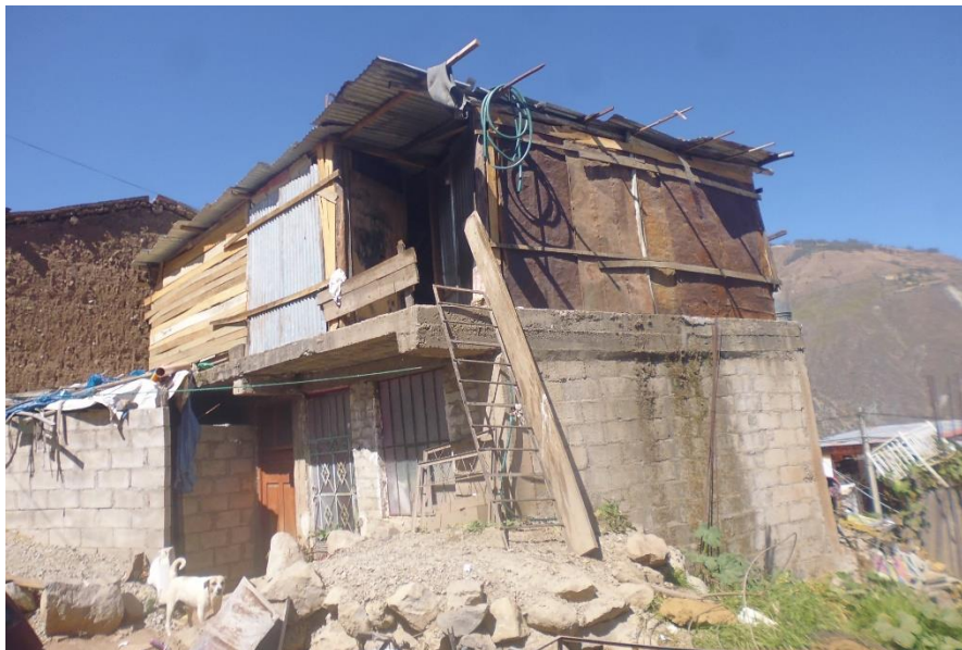
FOTO D-45: Se observa la fachada y deficiente estado de conservación de la vivienda.
