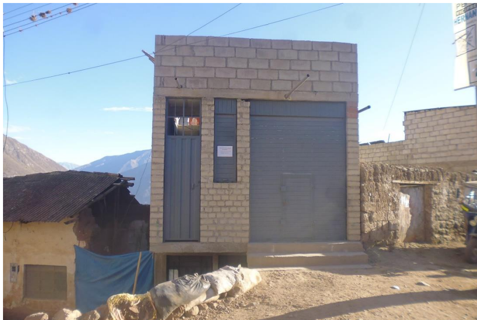
FOTO D-33: Se observa la fachada de la vivienda, con presencia de empuje de tierra.
