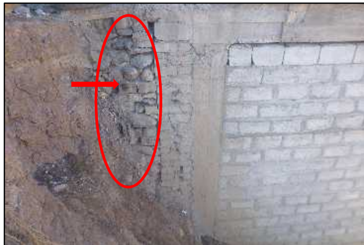
Figura 6.5: Muro soportando el empuje lateral del terreno sin diseño para actuar bajo este efecto.
