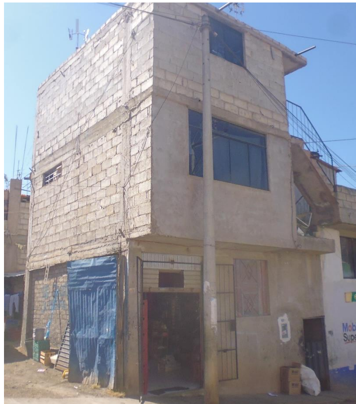
FOTO D-41: Se observa la fachada de la vivienda, con deficiente proceso constructivo.
