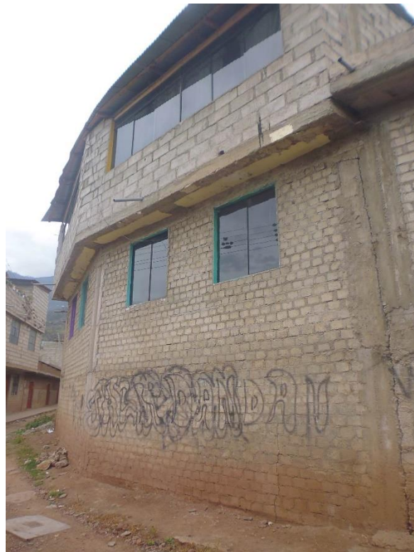
FOTO D-46: Falta de simetría y deficiencia en la construcción de la vivienda.
