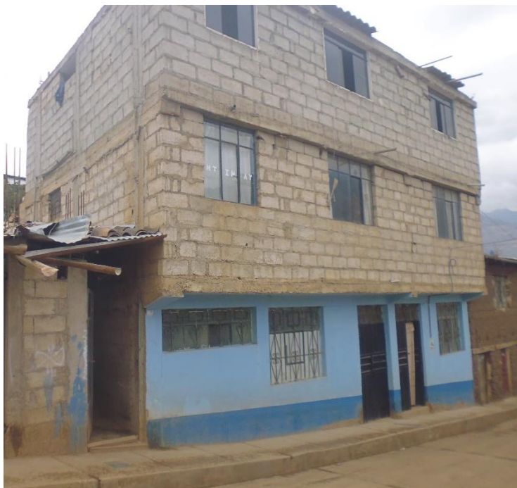
FOTO D-49: Deficiencias en la construcción de la vivienda.
