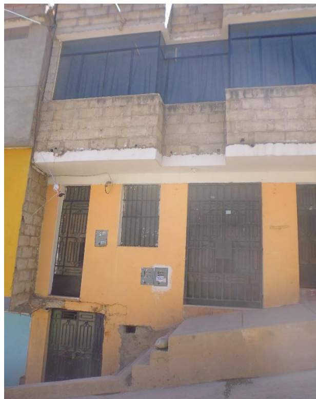
FOTO D-21: Se observa la fachada de la vivienda, losa en desnivel y errores arquitectónicos.
