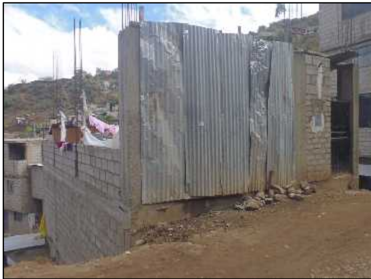
Figura 5.13: Edificación con presencia de empuje de suelo.
