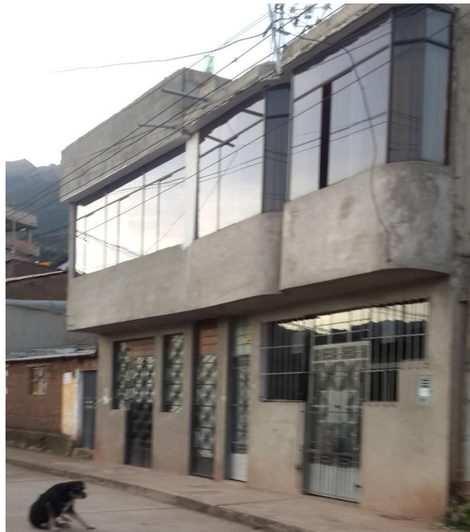
FOTO D-26: Se observa la fachada de la vivienda, con deficiente distribución de masa.
