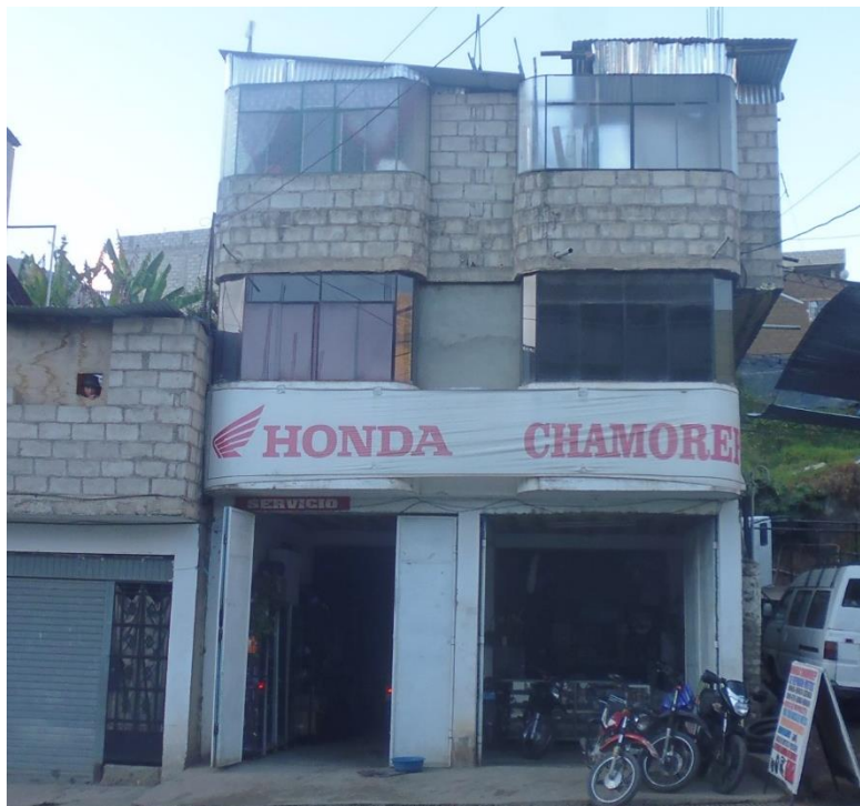
FOTO D-32: Se observa la fachada de la vivienda, sin junta sísmica y deficiente proceso constructivo.
