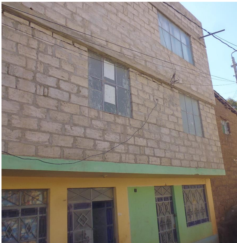
FOTO D-17: Se observa la fachada y asentado de muros con juntas variables (0-5cms)
