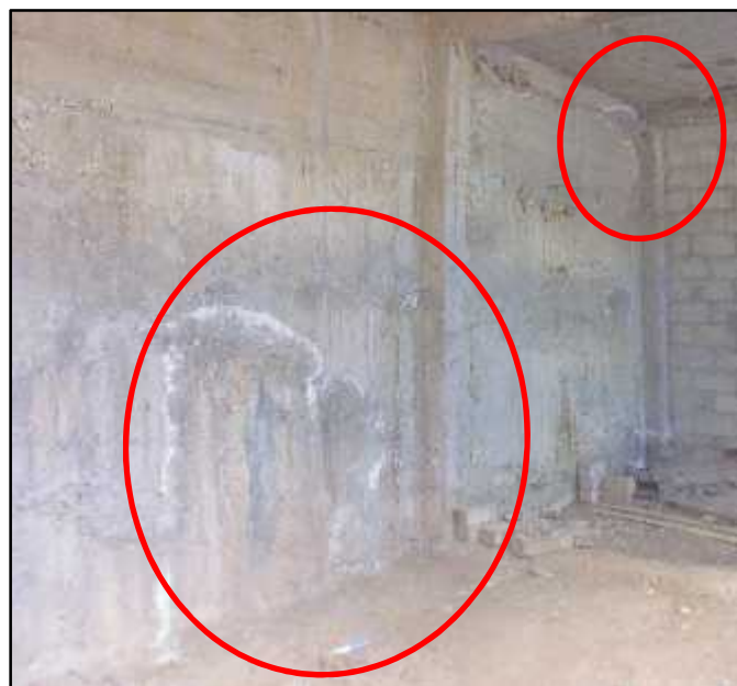
Figura 6.21: Muros con presencia de humedad
