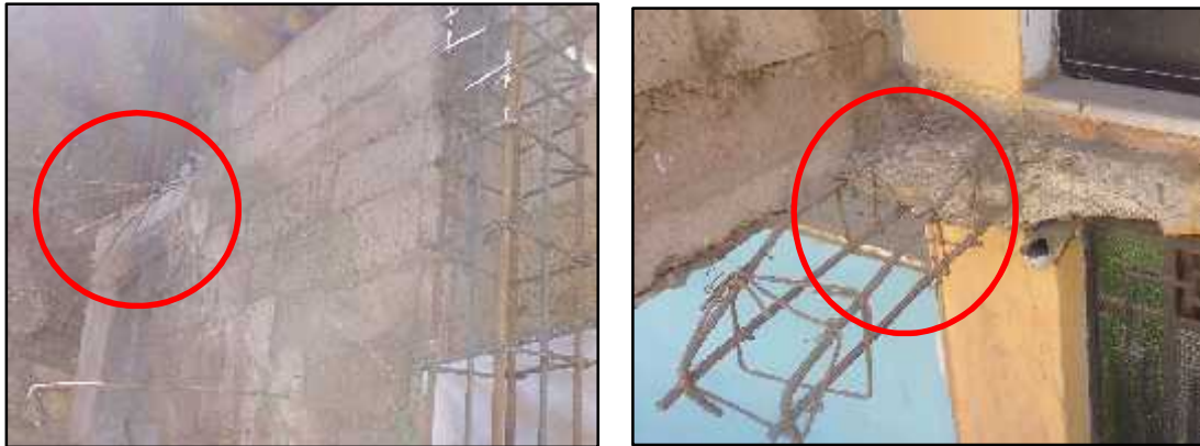
Figura 6.17: Junta fría en viga y viguetas de losa aligerada
