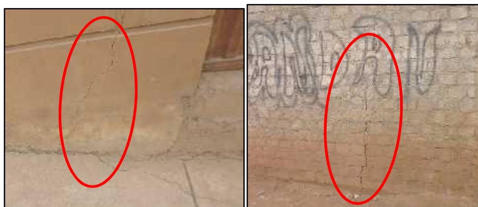
Figura 6.22: Muros agrietados por asentamientos
