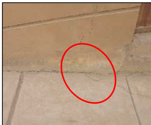
Figura 6.3: Fisura por asentamiento en vivienda sobre suelo arcilla-arenoso
