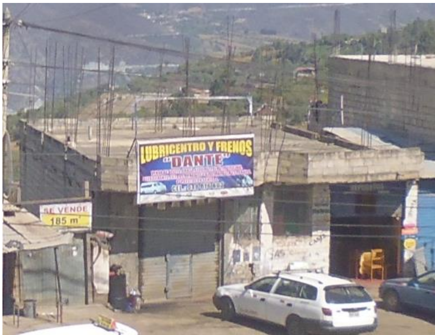
FOTO D-36: Se observa la fachada de la vivienda, con presencia de empuje de tierra y aceros expuestos y corroídos.
