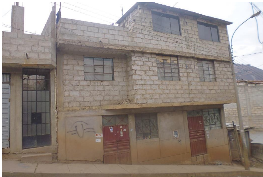
FOTO D-47: Falta de arriostre de los muros.
