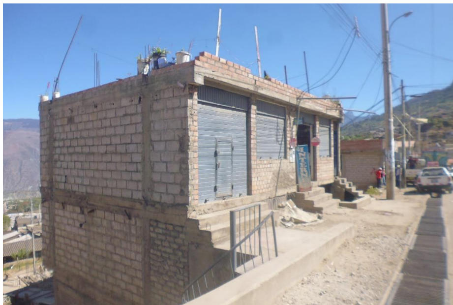
FOTO D-22: Se observa la fachada de la vivienda, y empuje de tierra.
