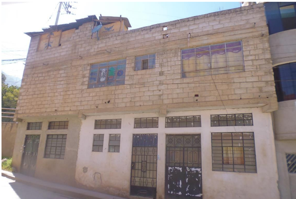
FOTO D-28: Se observa la fachada de la vivienda, con estado de conservación deficiente.
