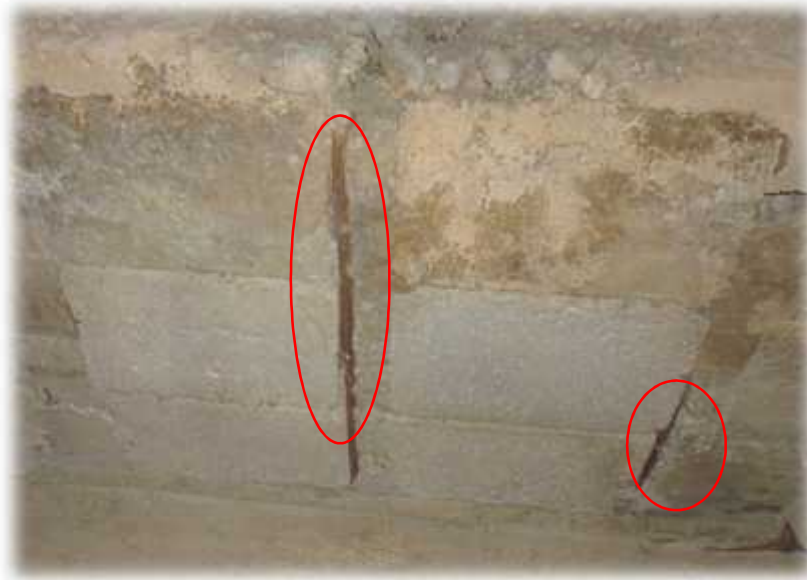
Figura 1.4: El concreto contiene cantos rodados, el acero de refuerzo de las viguetas están expuestos a la intemperie y el espaciamiento de viguetas es menor a lo indicado según el RNE (10cm).
