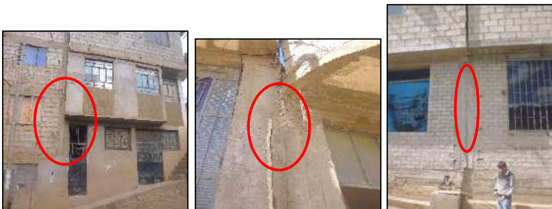
Figura 6.9. - Viviendas sin junta sísmica y losas de techo en desnivel
