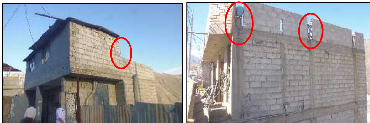
Figura 6.11: Tabiquería no arriostrada
