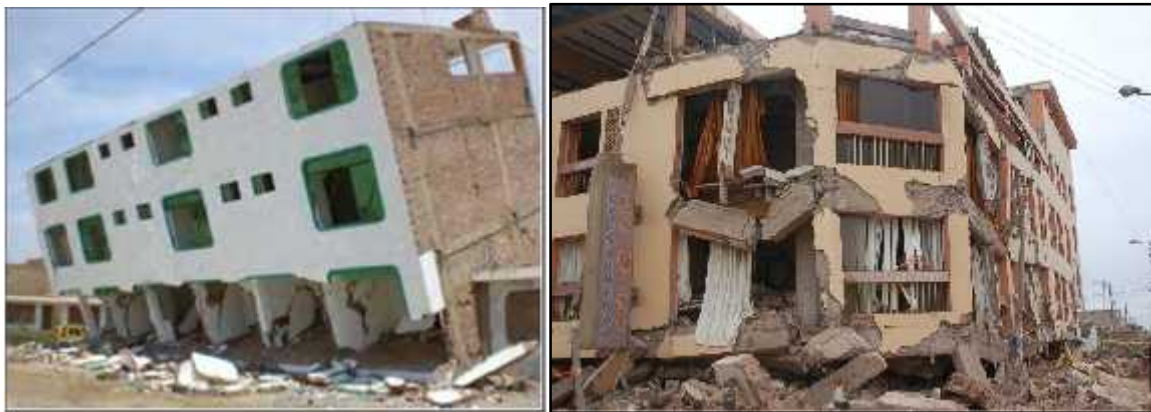
Figura 3.17: Daño observado en las edificaciones luego del terremoto de Pisco del 15 de agosto del 2007.
