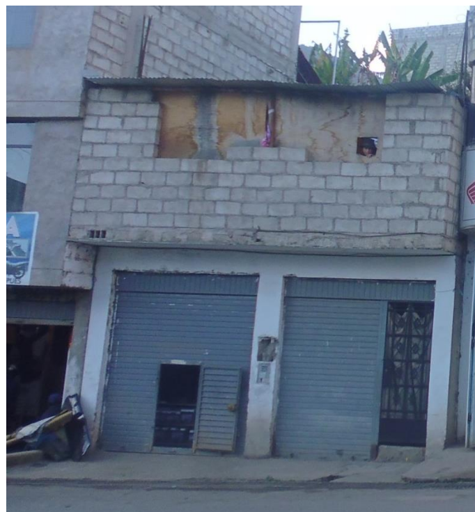
FOTO D-32: Se observa la fachada de la vivienda, sin junta sísmica y muros sin arriostre.
