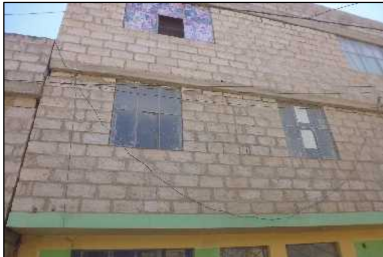
Figura 5.24: Edificación con excesiva separación de muros.
