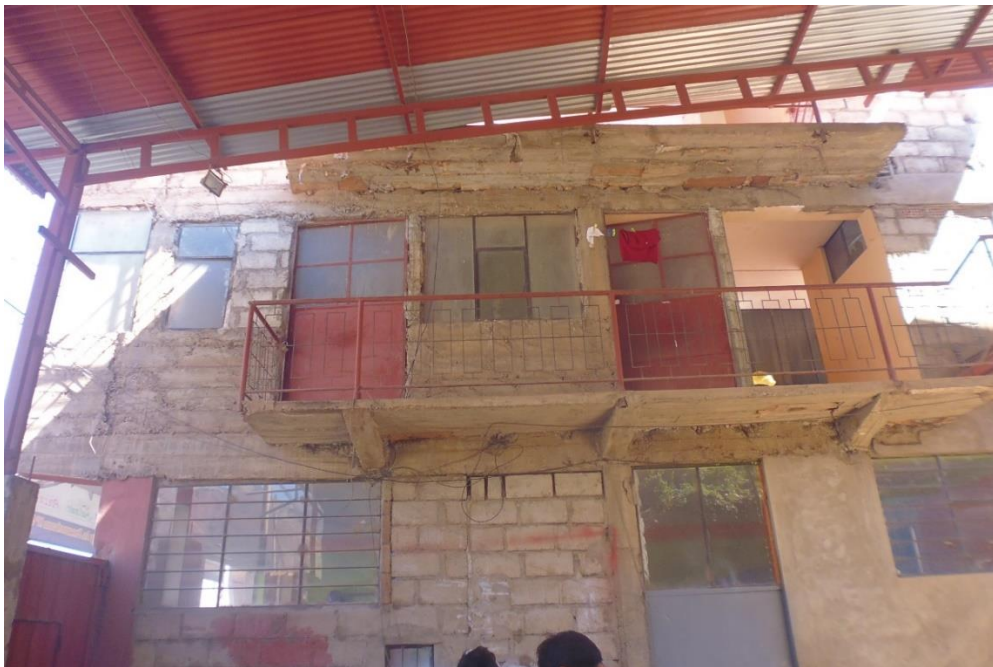
FOTO D-34: Se observa la vivienda, con deficiente proceso constructivo.
