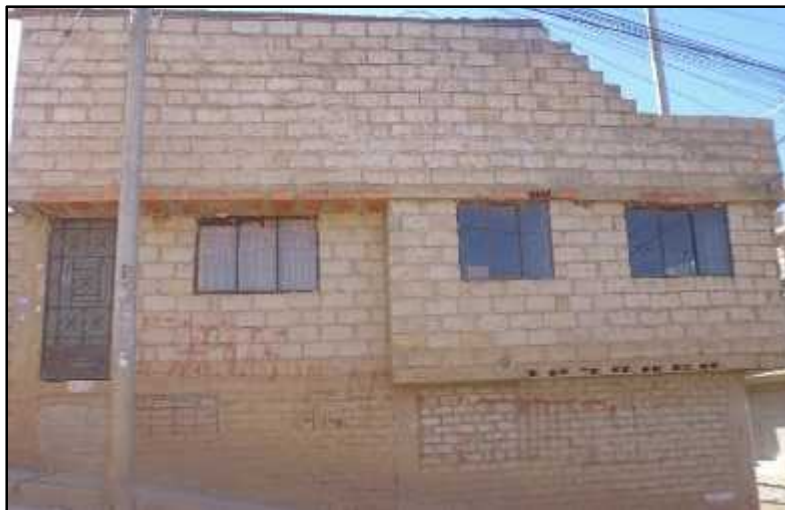
Figura 5.27: loza aligerada sin viga de borde y muro sin arriostrar.
