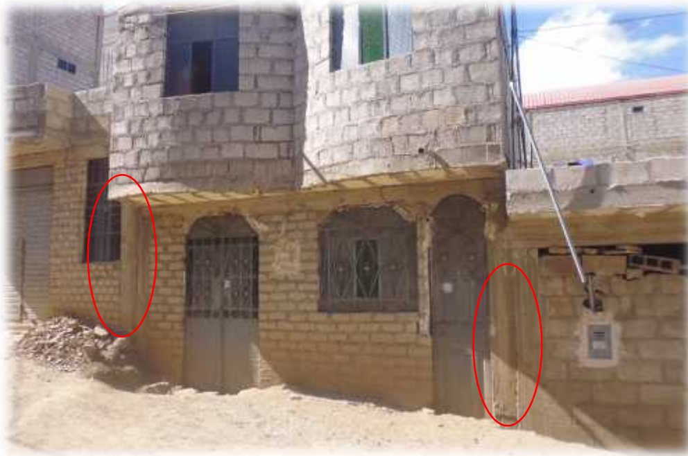
Figura 1.6: Viviendas sin junta sísmica.
