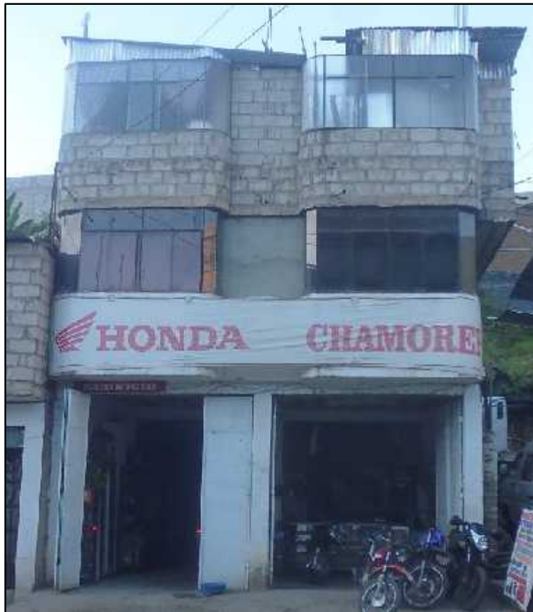
Figura 5.21: Edificación sin una adecuada distribución de masas.
