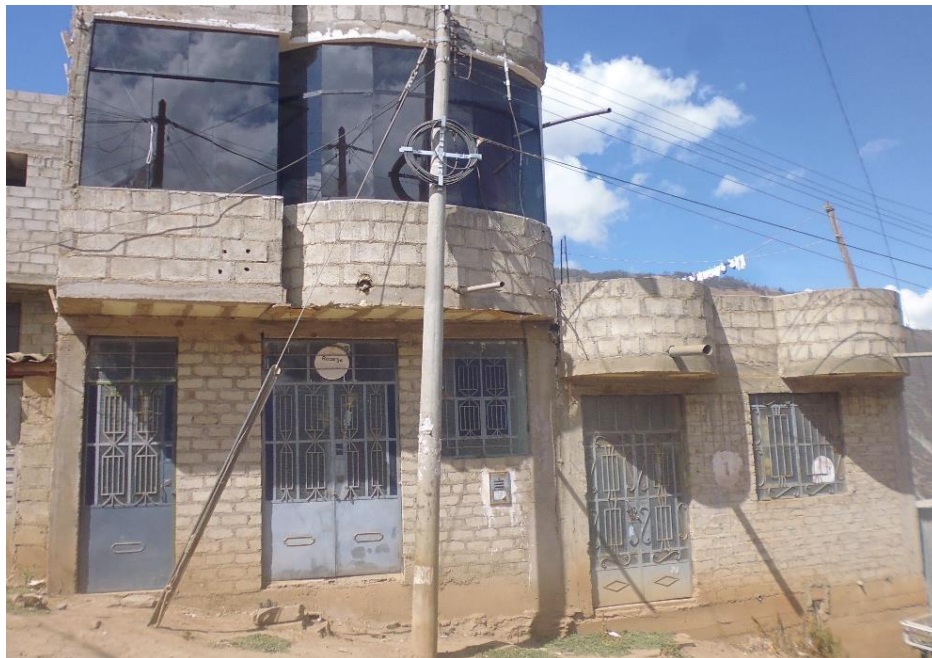
FOTO D-13: Se observa la fachada, vivienda sin junta sísmica.
