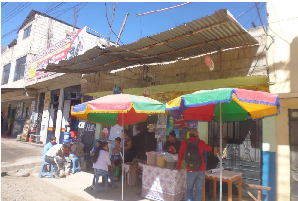
FOTO D-31: Se observa la fachada de la vivienda, con deficiente estado de conservación.
