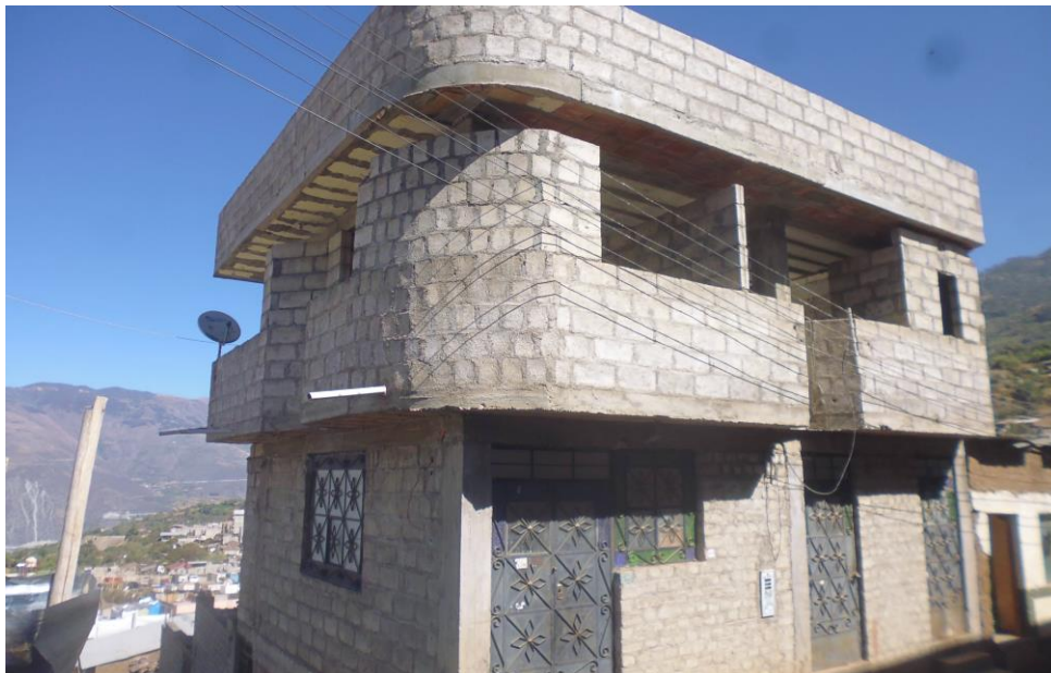
FOTO D-19: Se observa la fachada, con fallencias constructivas.
