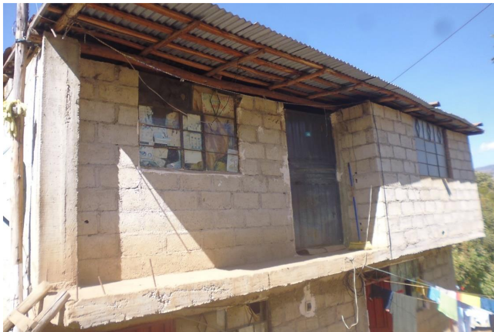
FOTO D-15: Se observa la fachada de vivienda y la falta de arriostre de muros.
