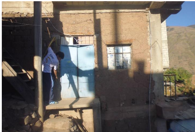
Foto D-5: Diafragma del 1er nivel con madera, con losa aligerada en el 2do nivel y con conexión deficiente.
