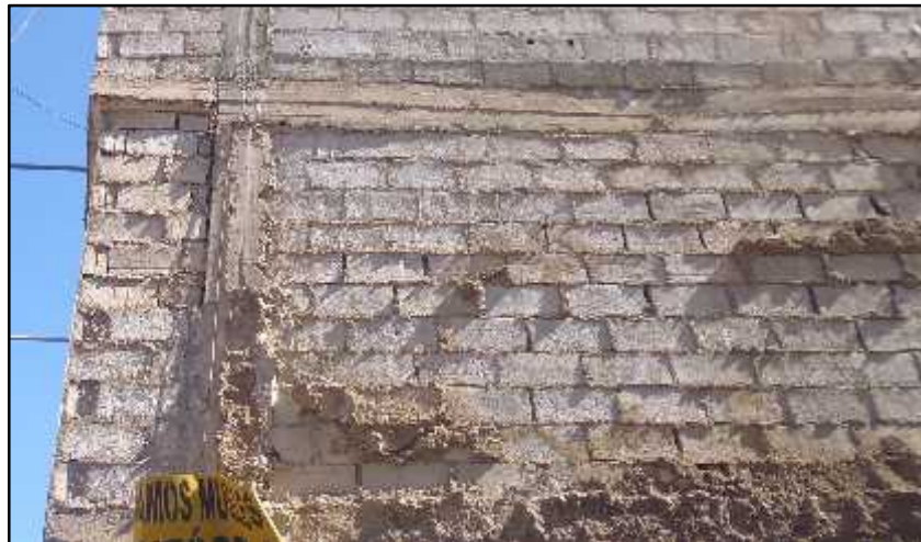
Figura 5.6: Asentado de muro sin la cantidad necesaria de mortero.
