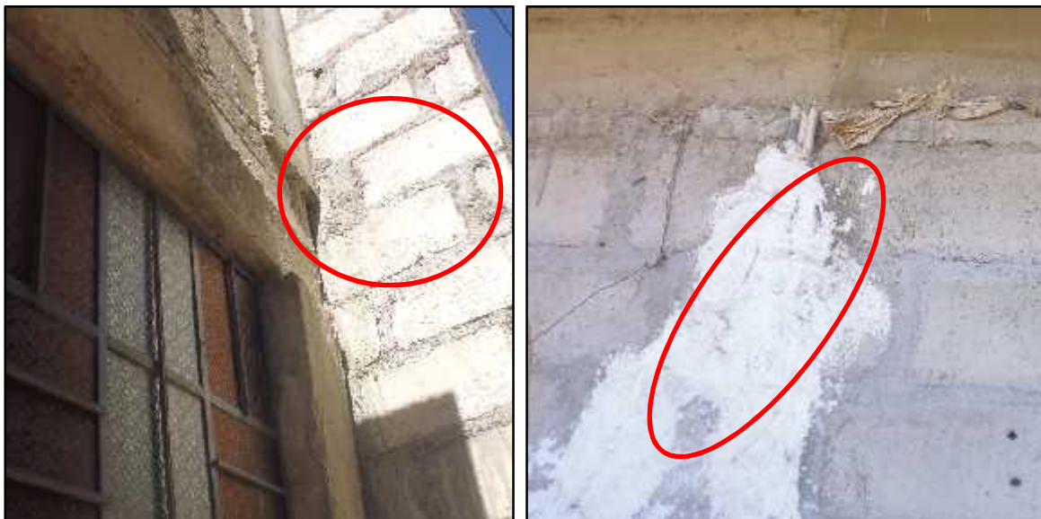
Figura 6.20: Calidad de construcción e instalación eléctrica deficiente.
