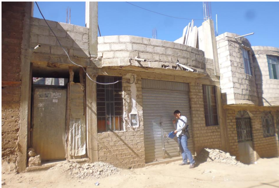
FOTO D-18: Se observa la fachada, vivienda sin junta sísmica.
