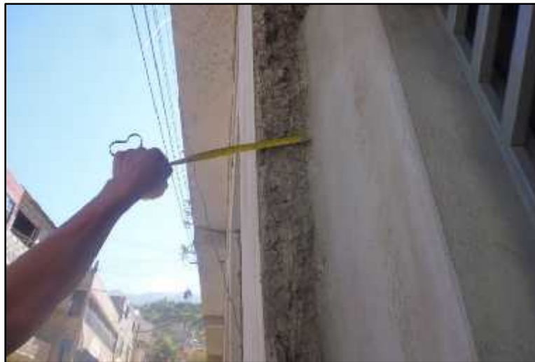
Figura 5.4: No existe continuidad en los sistemas resistentes, a causas: del empuje activo del suelo, vivienda sin muro de contención.
