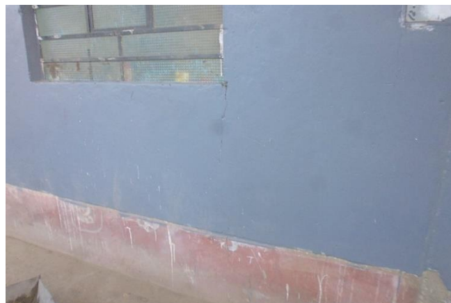
Foto D-9: Fisuras en muros
