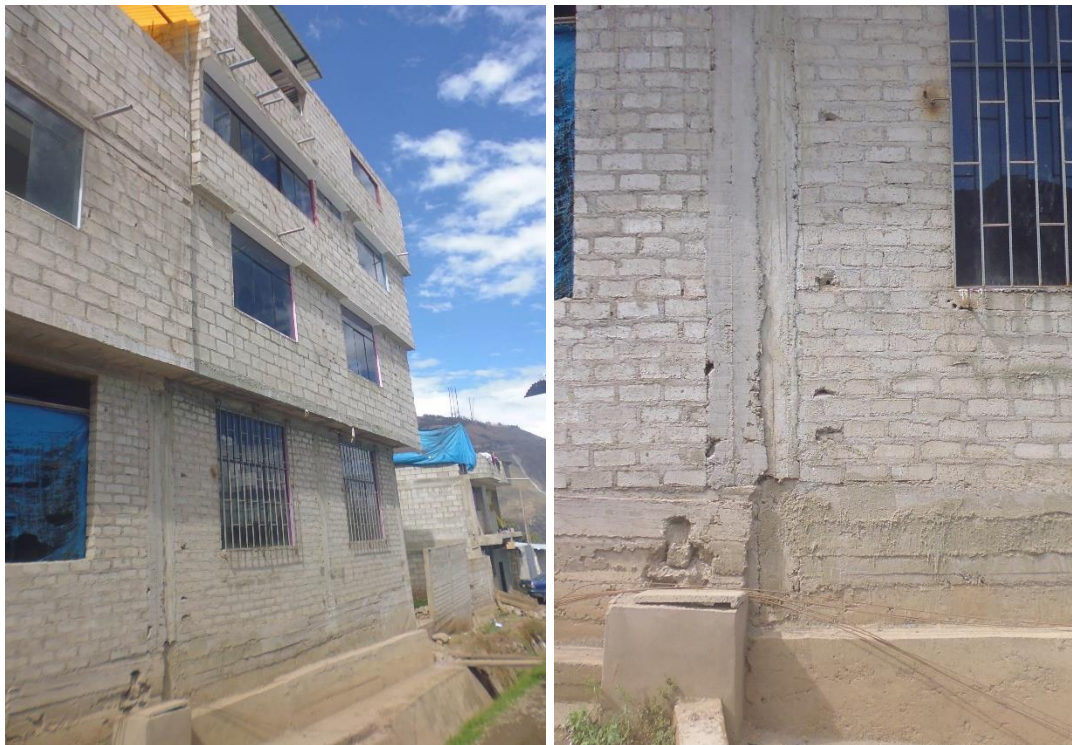
FOTO D-51: Errores constructivos de la vivienda.
