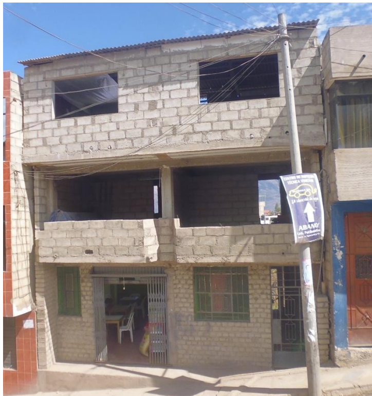
FOTO D-37: Se observa la fachada de la vivienda, con deficiente proceso constructivo.
