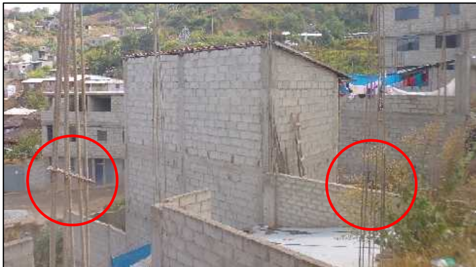
Figura 6.16: Acero de refuerzo expuesto a la intemperie
