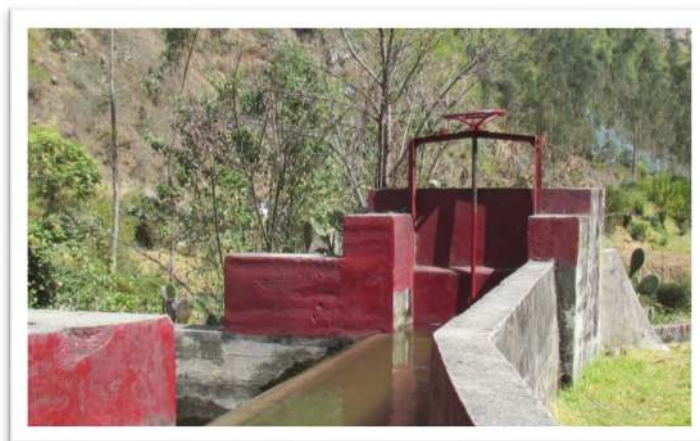
Fotografía N° 07: Canal Mariño – Compuerta Puruchaca – Sector Puruchaca
