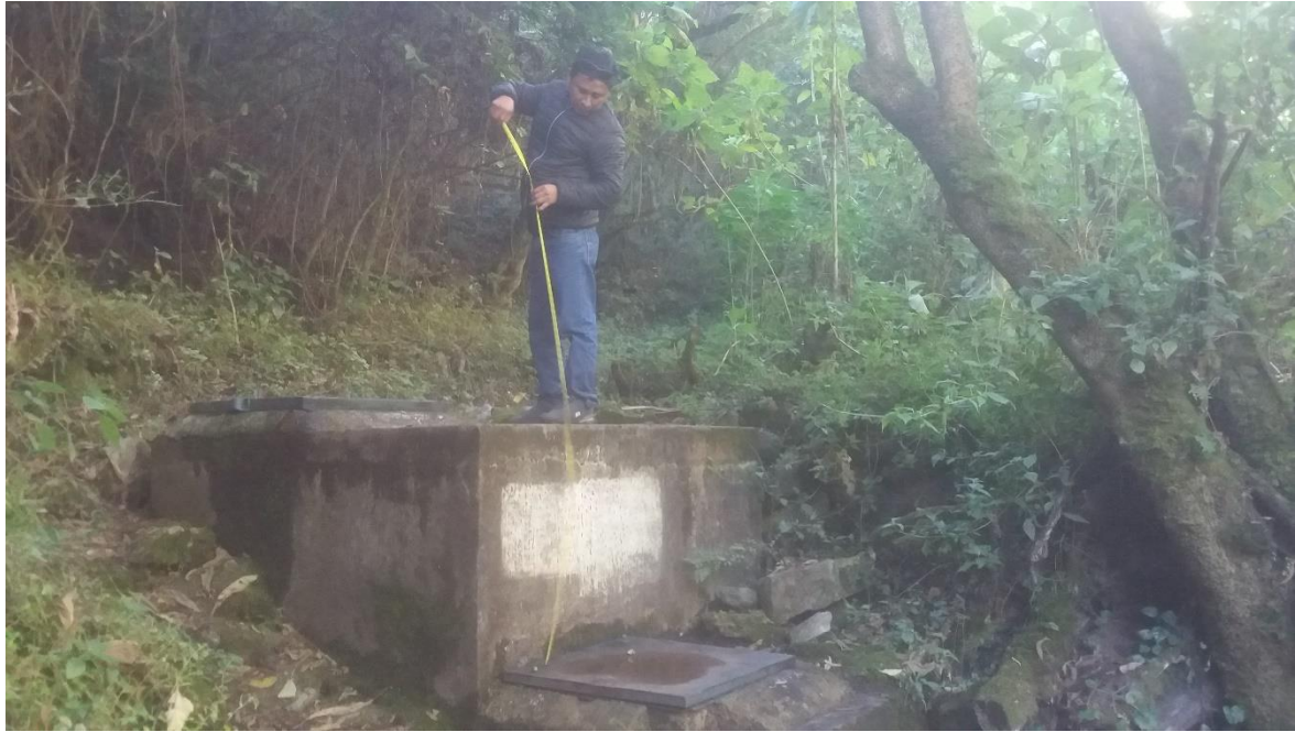
a. Captación del manante marcamarca - año 2019
